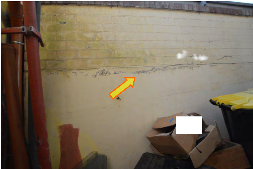
Feuchtigkeitsschäden an der rechten Seite
