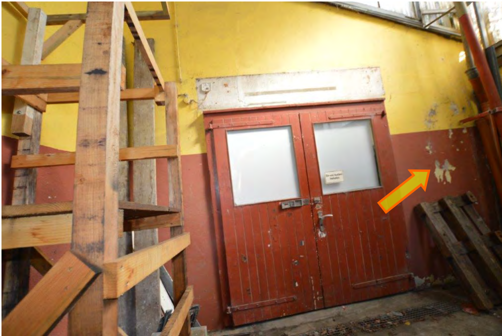
Tor unter der Überdeckung und Außenputzschäden
