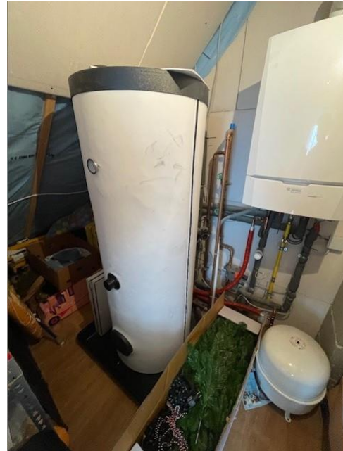
Bild 14: Heizung mit Warmwasserspeicher SB
