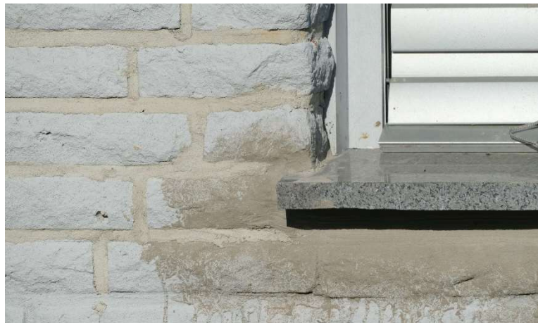
A8 Farbauftrag unterhalb der Fensterbank durch Mörtel und Schaumkleyer verunreinigt
