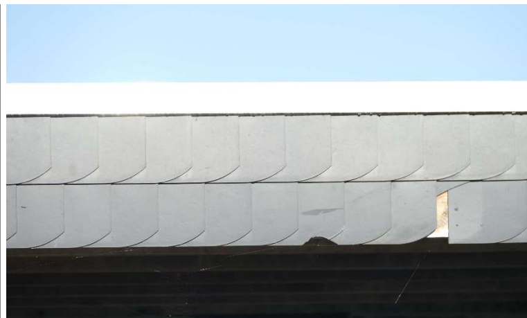
B1 Schindeln in Teilen beschädigt
