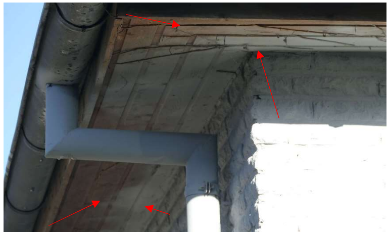
A2 Holzverkleidung der Dachüberstände tlw. beschädigt, tlw. mit unregelmäßigem Farbanstrich
