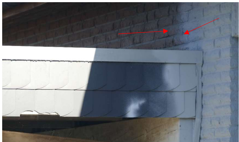
A3 Farbe (Spritztechnik) nicht auf der gesamten Gebäudefassade aufgetragen
