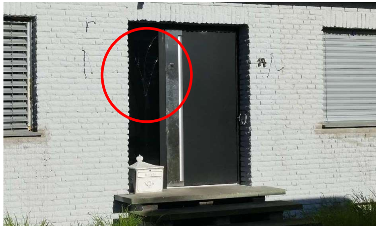
A7 Glasscheibe (feststehendes Element) der Haustür beschädigt
