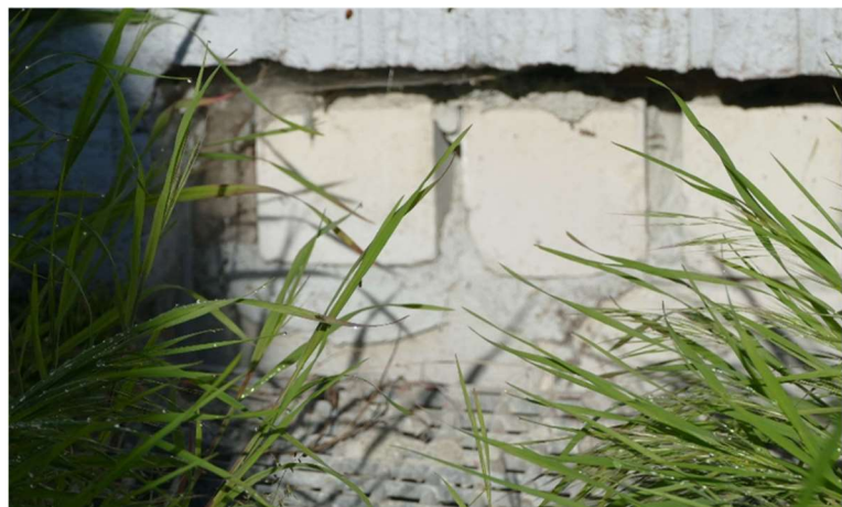
A9 Maueröffnung des Kellerfensters geschlossen Kalksandsteinmauerwerk sichtbar; ohne Witterungsschutz
