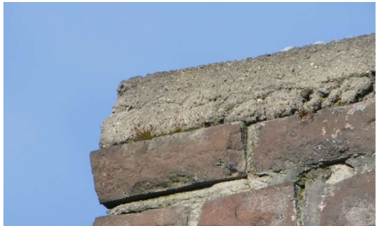
A1 Fugen des Kaminkopfs (Verblendmauerwerk) „ausgewaschen“
