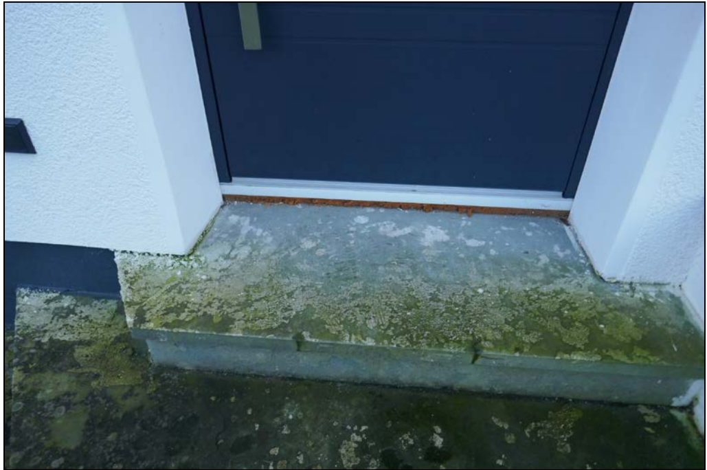
Anschluss Haustür – nicht ordnungsgemäß fertiggestellt
