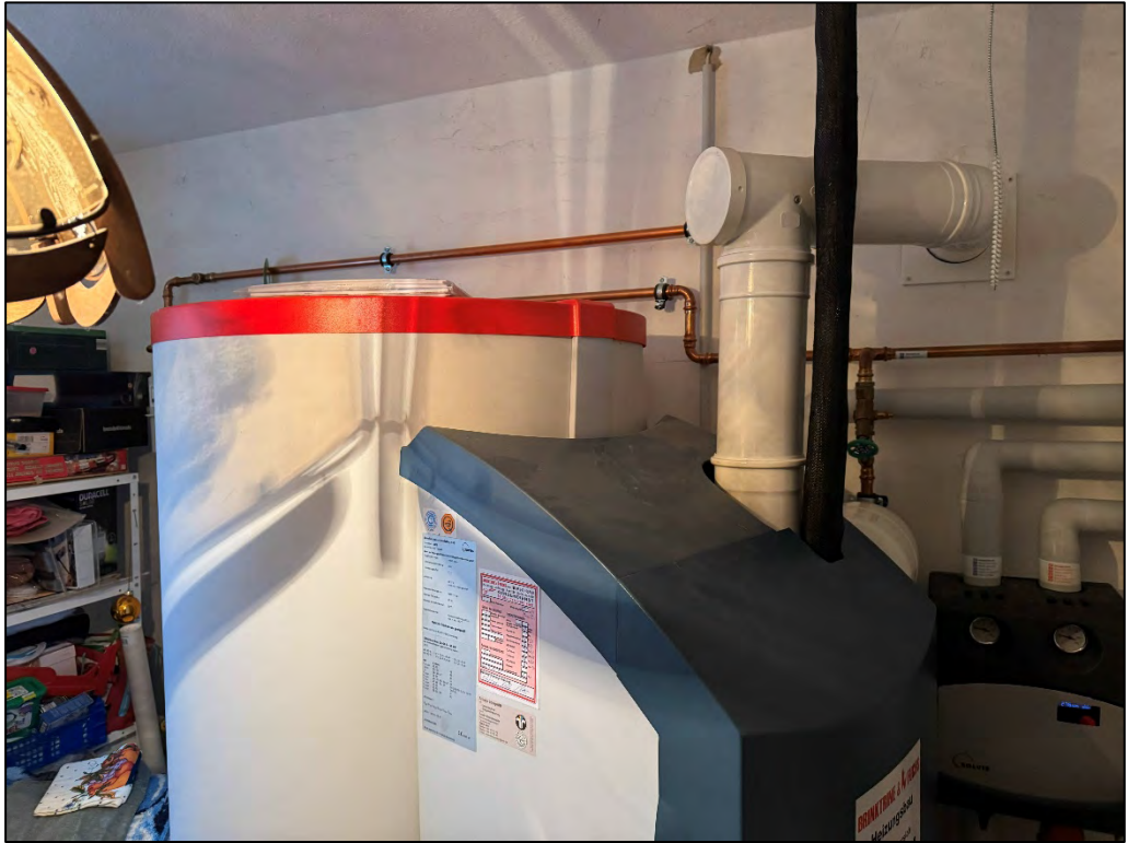
Heizung Haus Nr. 11b
