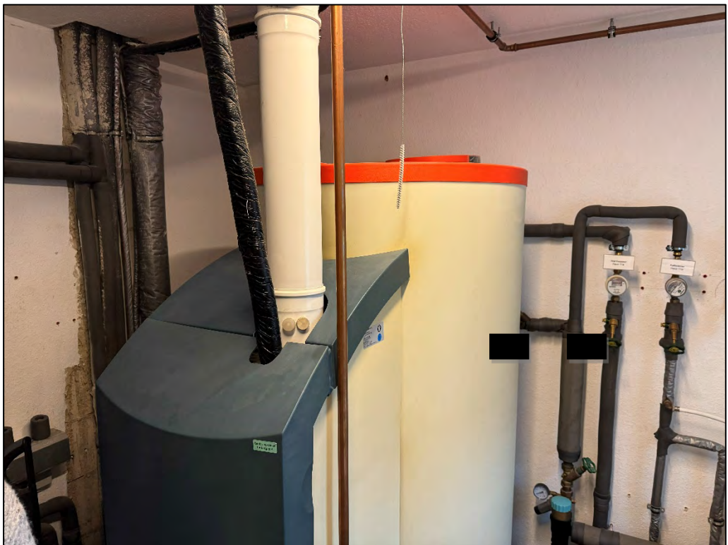
Heizung Haus Nr. 11a
