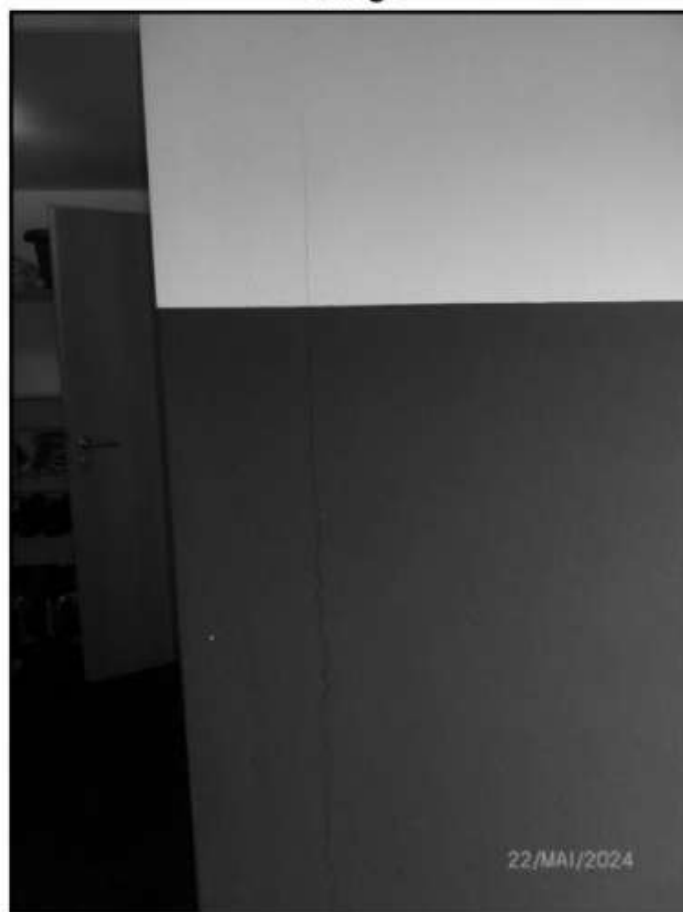
Garage – Riss in der Wand zum Abstellraum
