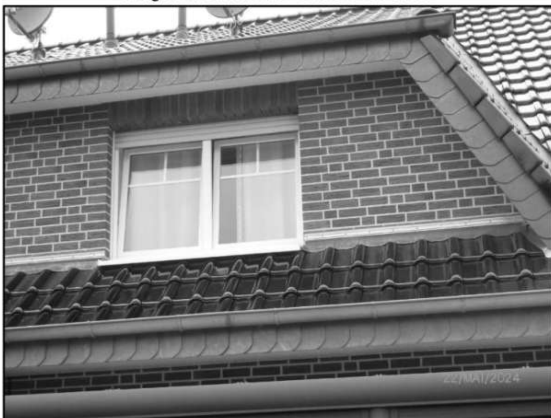
Schleppdachgaube (tlw. fehlende Verfugung des Fenstersturzes)
