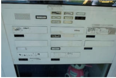
Blick auf die Briefkastenanlage
