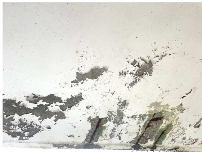
Wohnung Nr. 2: Untersicht Balkon über der Terrasse
