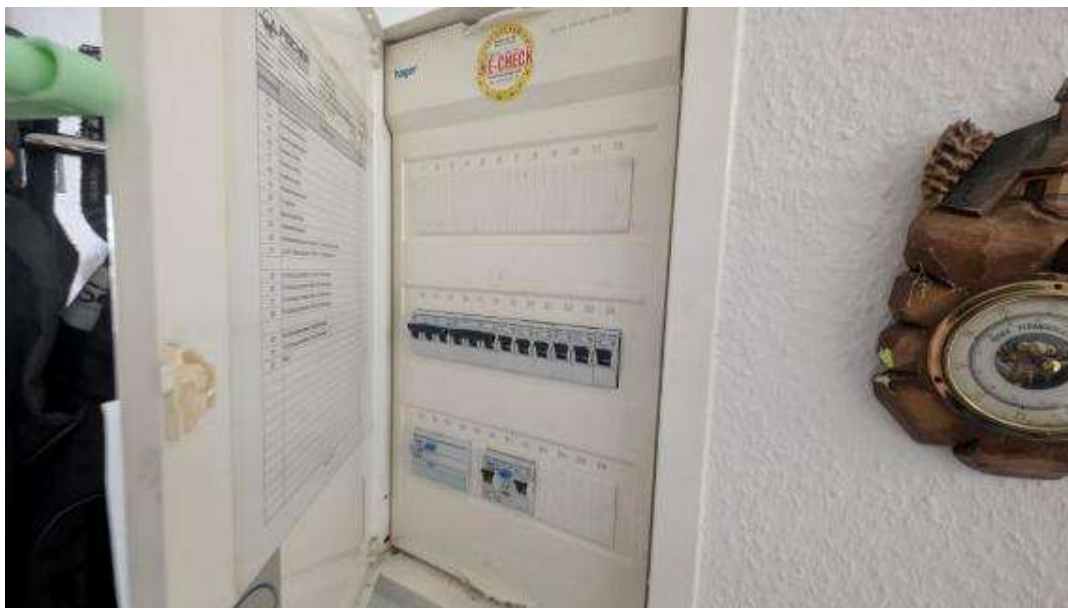
Bild D5 Beispiel Haustechnik
