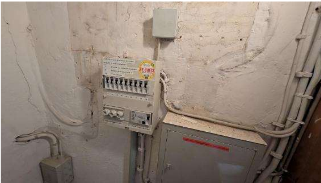
Bild D3 Beispiel Haustechnik
