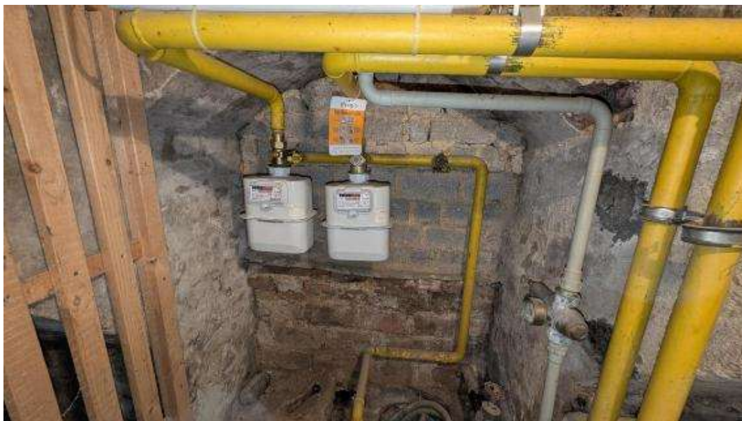
Bild D1 Beispiel Haustechnik
