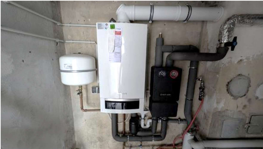
Bild D8 Beispiel Haustechnik
