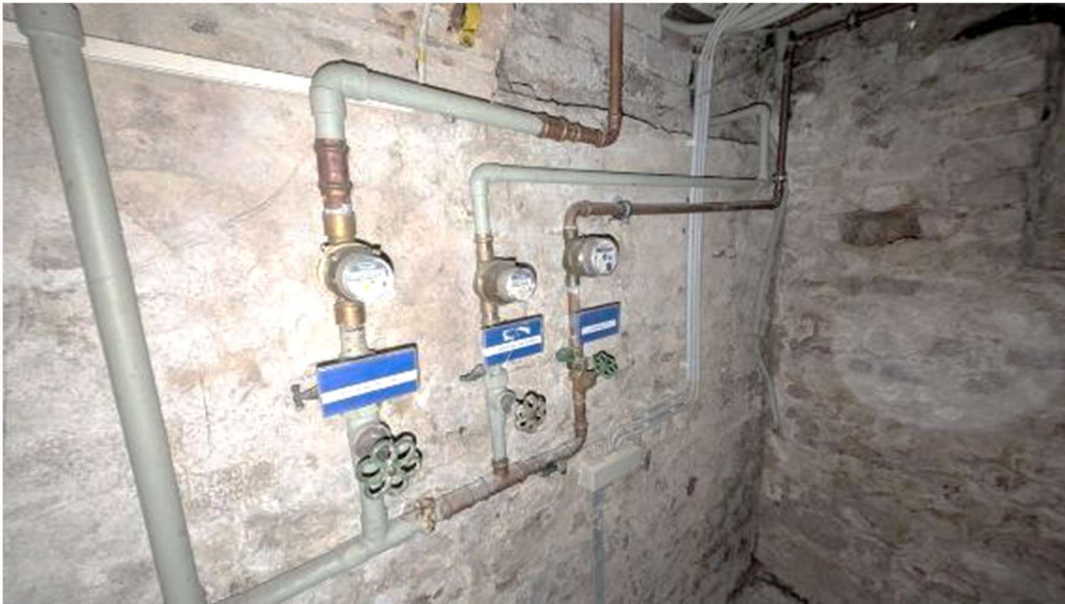
Bild D2 Beispiel Haustechnik
