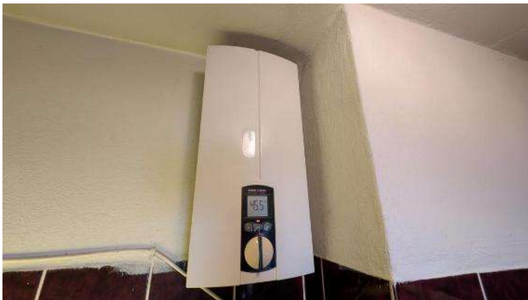
Bild D7 Beispiel Haustechnik
