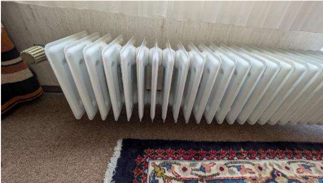
Bild D10 Beispiel Haustechnik
