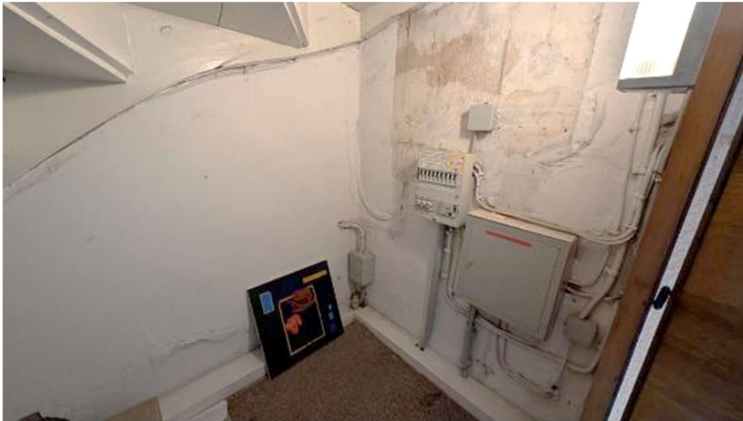
Bild D4 Beispiel Haustechnik
