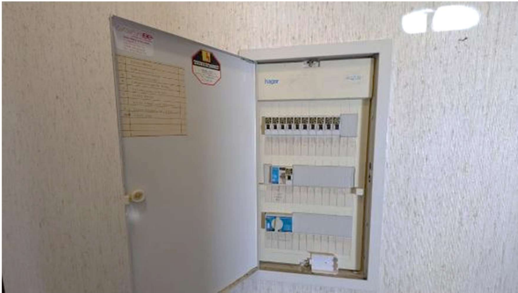
Bild D6 Beispiel Haustechnik
