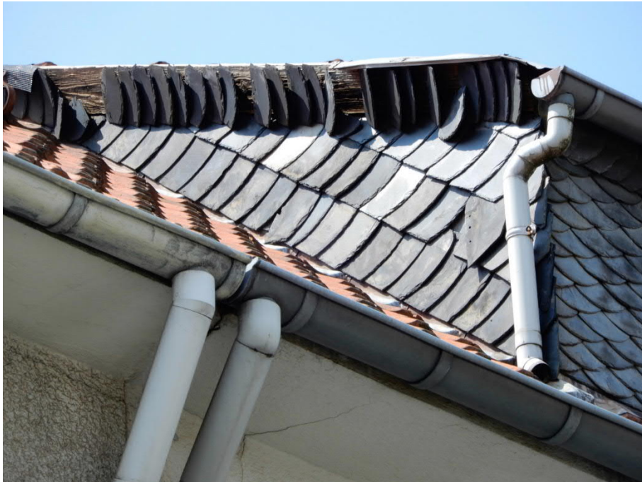
Schaden am Ortgang der straßenseitigen linken Dachgaube
