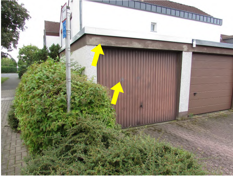
Foto 7: PKW-Garage (Flurstück 4420): fleckige, z.T. abblätternde Lackierung des Garagentores, verwitterter Farbanstrich im Dachabschlußbereich
