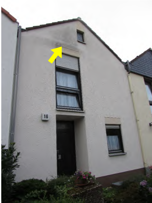
Foto 1: Wohnhaus (Flurstück 4422) "Kösliner Weg XX", 53340 Meckenheim: fleckige Fassade
