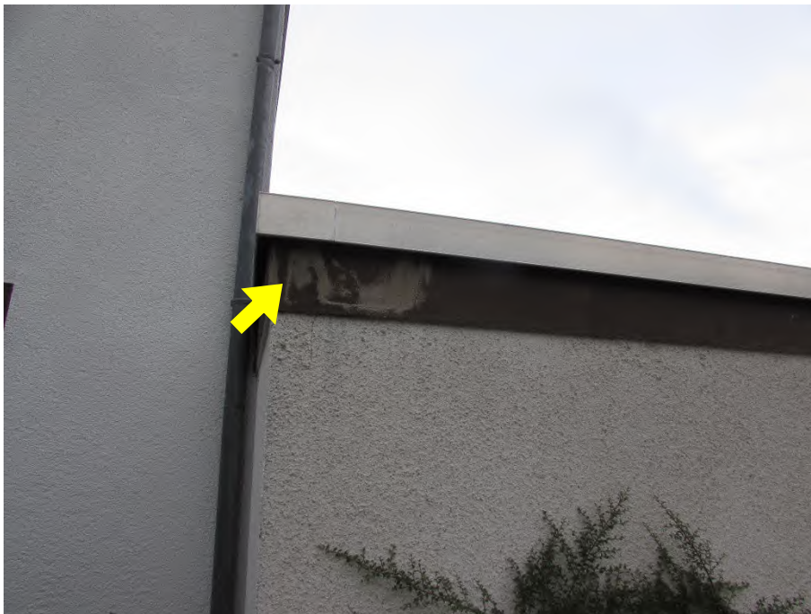
Foto 8: PKW-Garage: abblätternder Farbanstrich im Dachabschlußbereich
