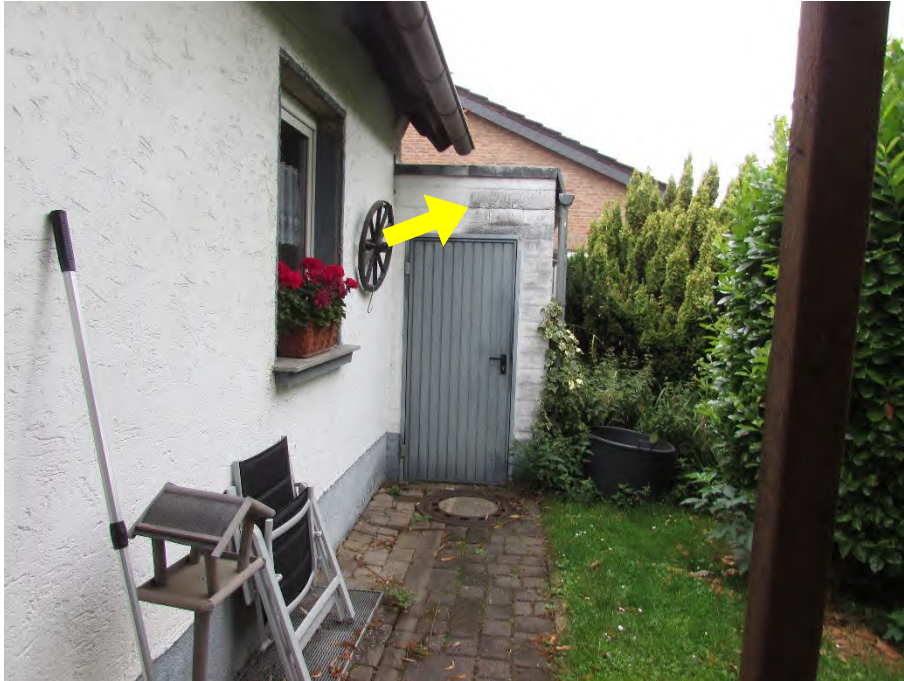
Foto 7: PKW-Garage, Gartenansicht: fleckige Fassade
