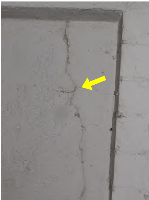
Foto 8: Riß in der Wand zwischen Wohnhaus und Garage
