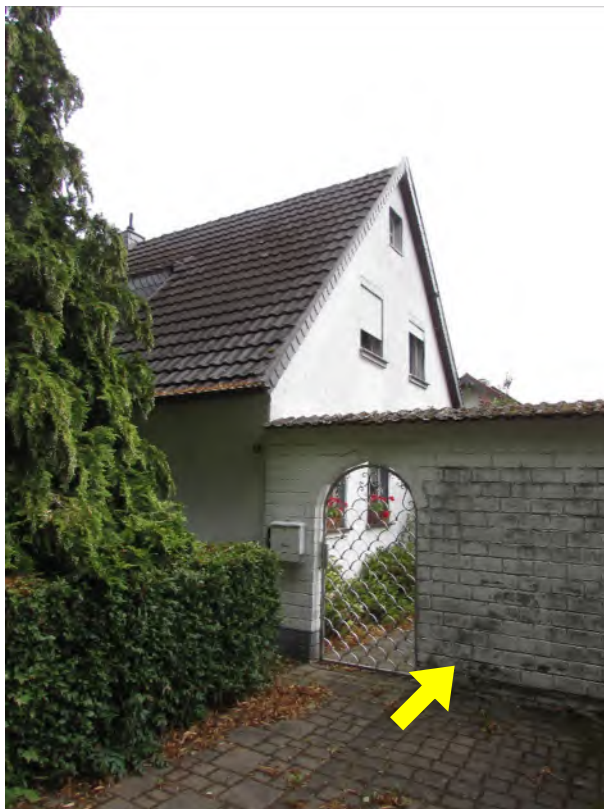
Foto 10: Zugang, fleckiges Mauerwerk
