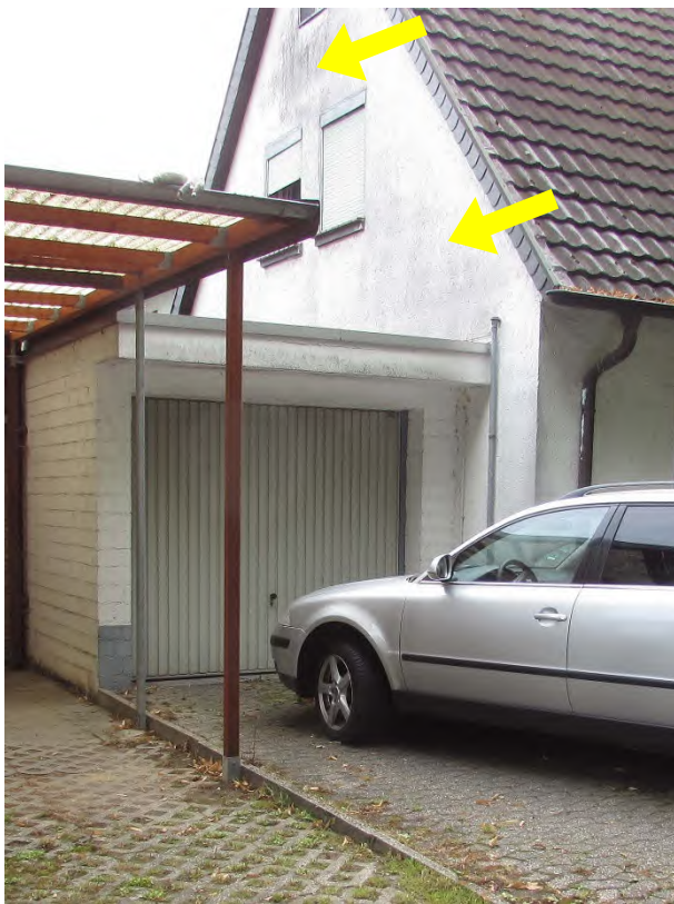
Foto 6: PKW-Garage, Straßenansicht, fleckige Wohnhaus-Fassade
