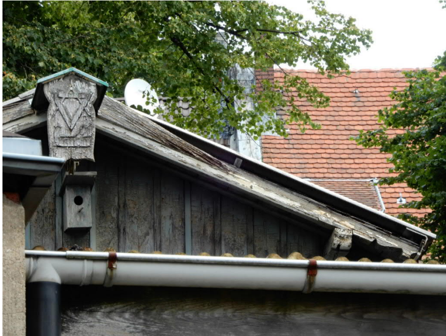
Schaden am Ortgang (Werkstattgebäude)
