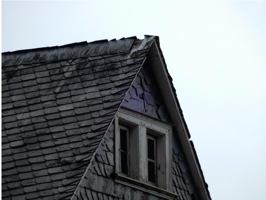
Schaden am Giebel Wohn- und Geschäftshaus
