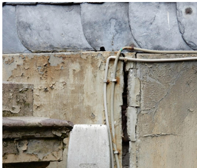
Fassadenschaden Wohn- und Geschäftshaus, beispielhaft
