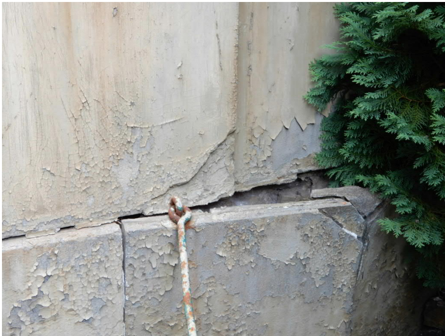
Fassadenschaden Wohn- und Geschäftshaus, beispielhaft
