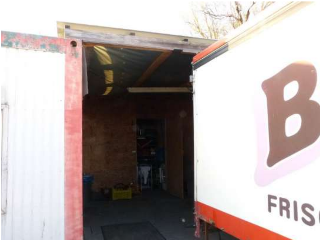
Anbau an der angebranten Halle
