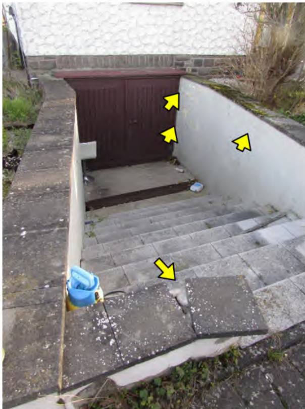
Foto 4: Kelleraußentreppe: Stützwandbereich mit Rissen, Putzschäden und Feuchtigkeit, lose Betonplattenabdeckung
