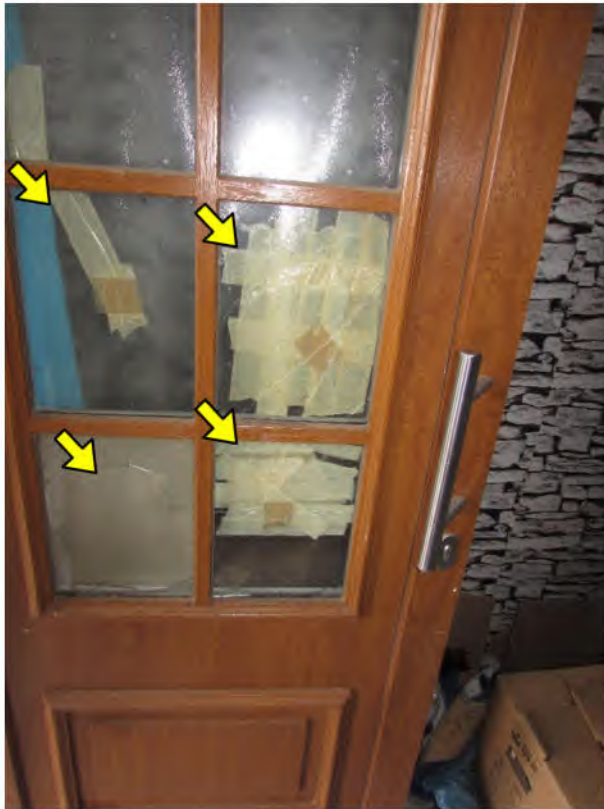
Foto 3: Hauseingangstür: beschädigte Glasfüllung
