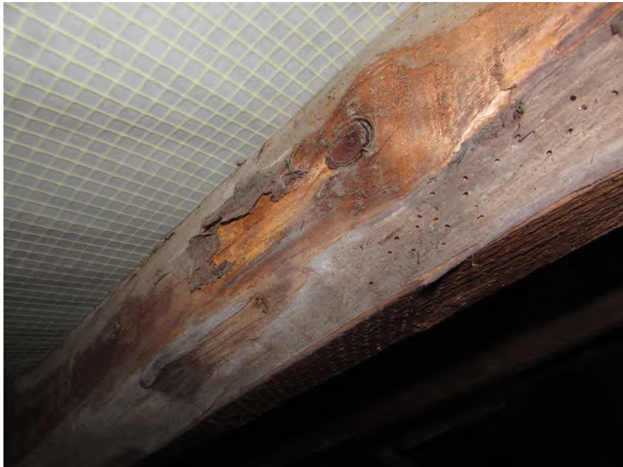
Foto 10: Dachspitze/Spitzboden: Spuren von Holzwurmbefall
