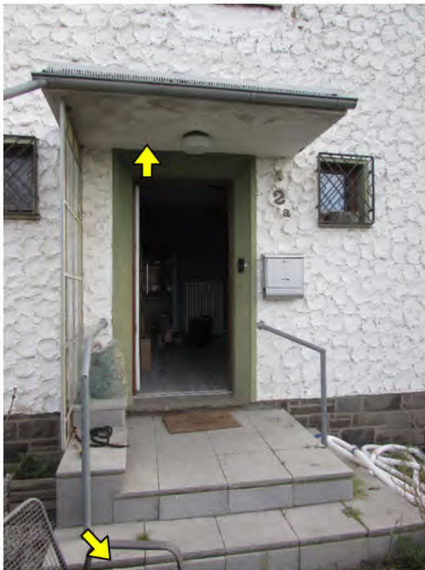
Foto 2: Hauseingang: fleckige Untersicht der Überdachung, lose Betonplatten des Eingangspodestes
