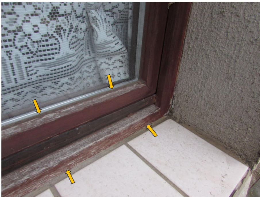
Foto 6: Wohnhaus, verwitterte Holzfenster (exemplarisch)
