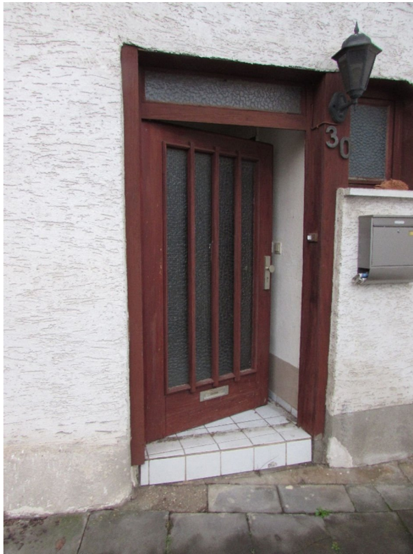
Foto 7: Wohnhaus, überalterte Hauseingangstür
