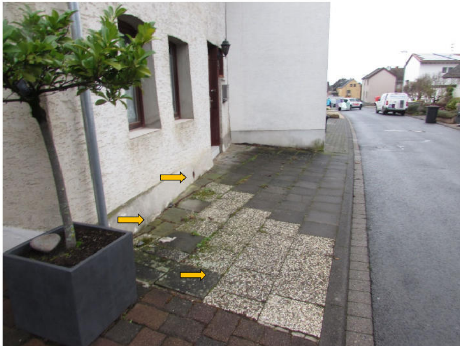
Foto 5: Zugang, z.T. abgesetzte Beton- und Waschbetonplatten
