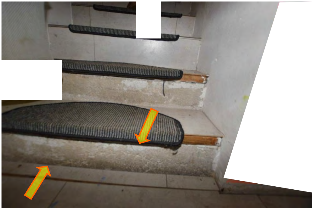
EG – Treppe zum DG fehlende Bekleidung
