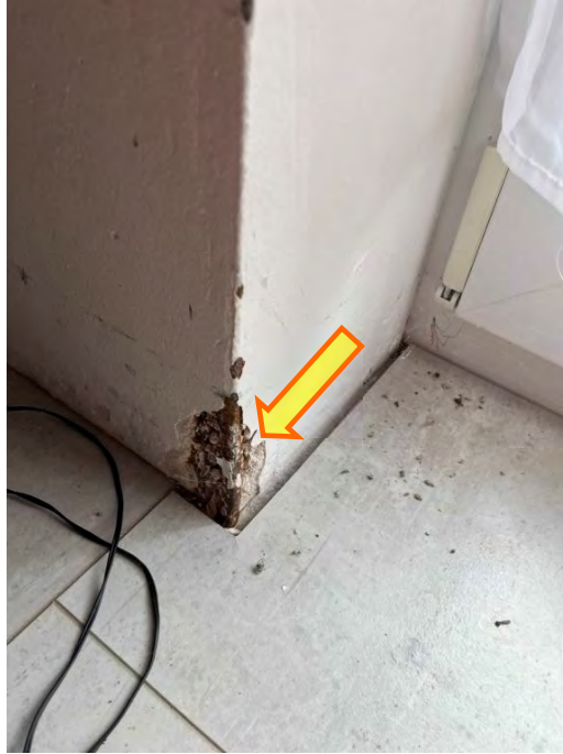
EG – Putzschäden (Beispiel)
