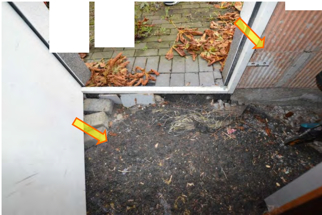
Garage – fehlende Bodenplatte, fehlender Estrich, fehlender Putz
