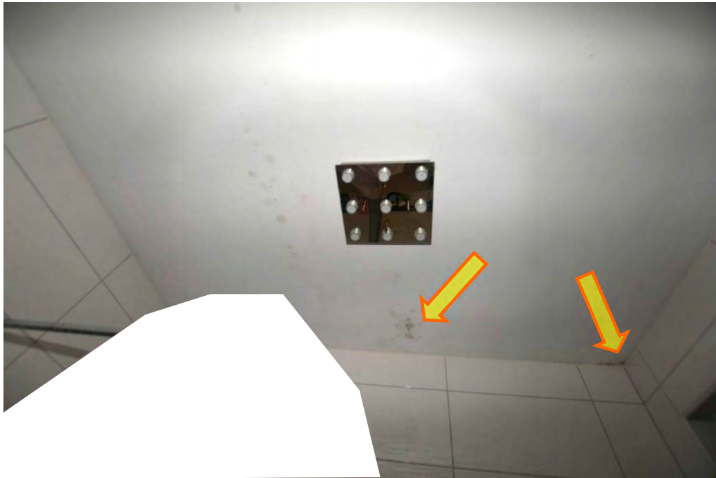
EG – WC/ Dusche Schimmelschäden (Beispiel)
