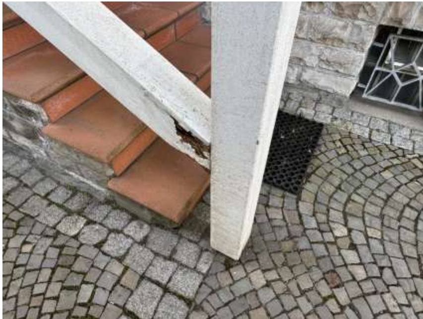
Bild 17: Beispiel für verfaultes Holz der Überdachung Eingangsbereich
