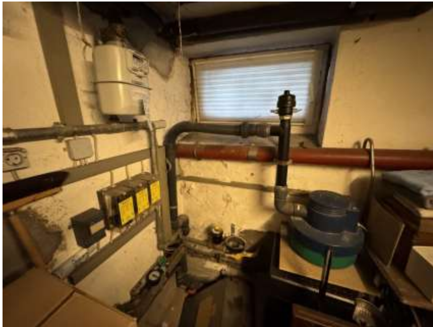
Bild 19: Pumpenanlage des Whirlpools zur Kanalisation
