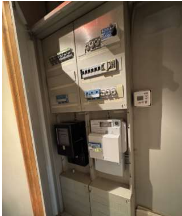
Bild 21: Elektrokasten im Treppenhaus
