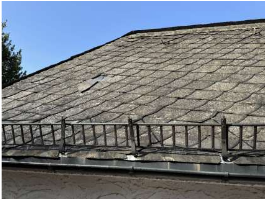
Bild 15: Beispiel für lockere Schiefersteine auf dem Garagendach
