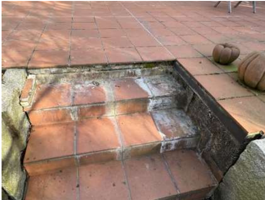
Bild 11: Beispiel für gebrochene Fliesen der Terrasse
