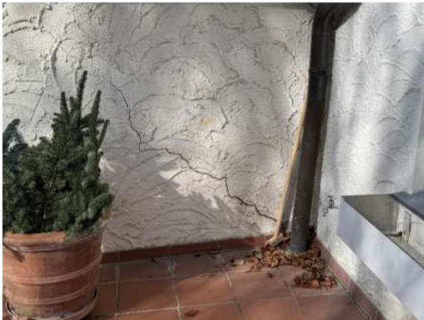
Bild 10: massive Rissbildung in den Außenmauern der Garage
