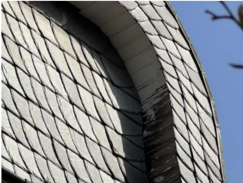
Bild 13: Beispiel für notwendigen Anstrich des Dachüberstandes (hier Gaube)
