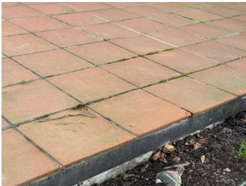
Bild 12: Beispiel für gebrochene und abgängige Fliesen der Terrasse
