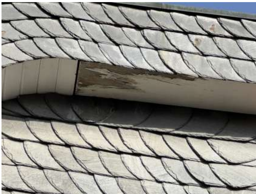
Bild 14: Beispiel für notwendigen Anstrich des Dachüberstandes (hier Gaube)
