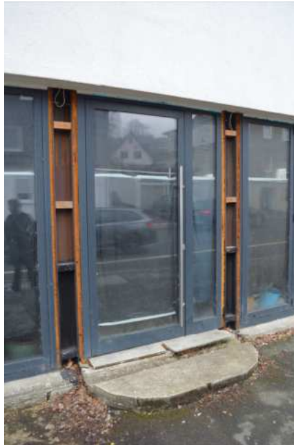
Bild 19: Zugang Ladenlokal (fehlende Fenster-/Eingangstürverkleidung)
