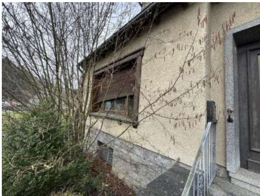
Bild 22: defekter Rollladen neben der Haustür
