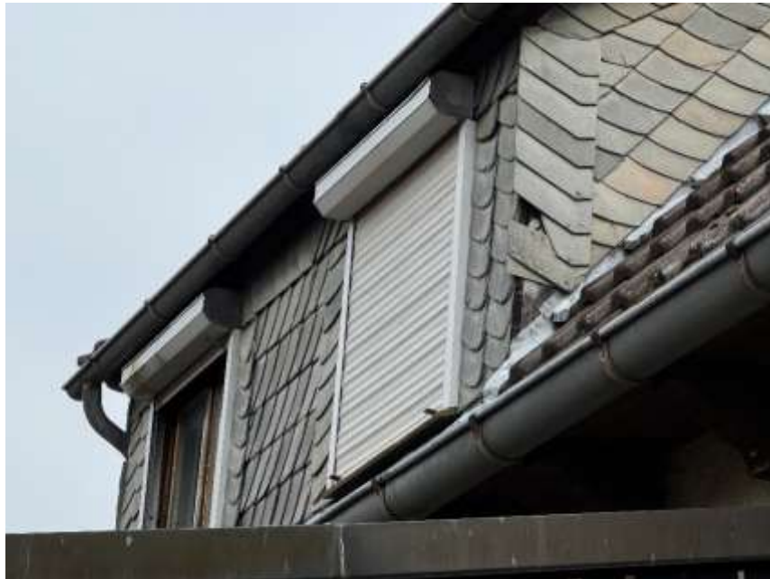
Bild 21: Beispiel für fehlende Schiefersteine an der Dachgaube
