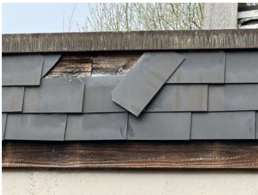
Bild 16: lockere Eternitsteine Attika Garage
