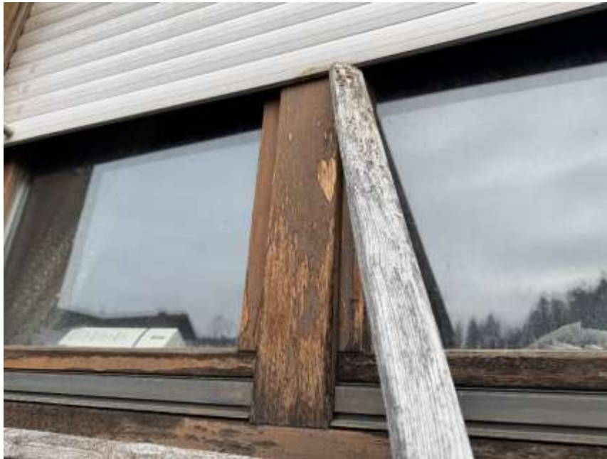
Bild 19: Beispiel für defekte Rollläden
