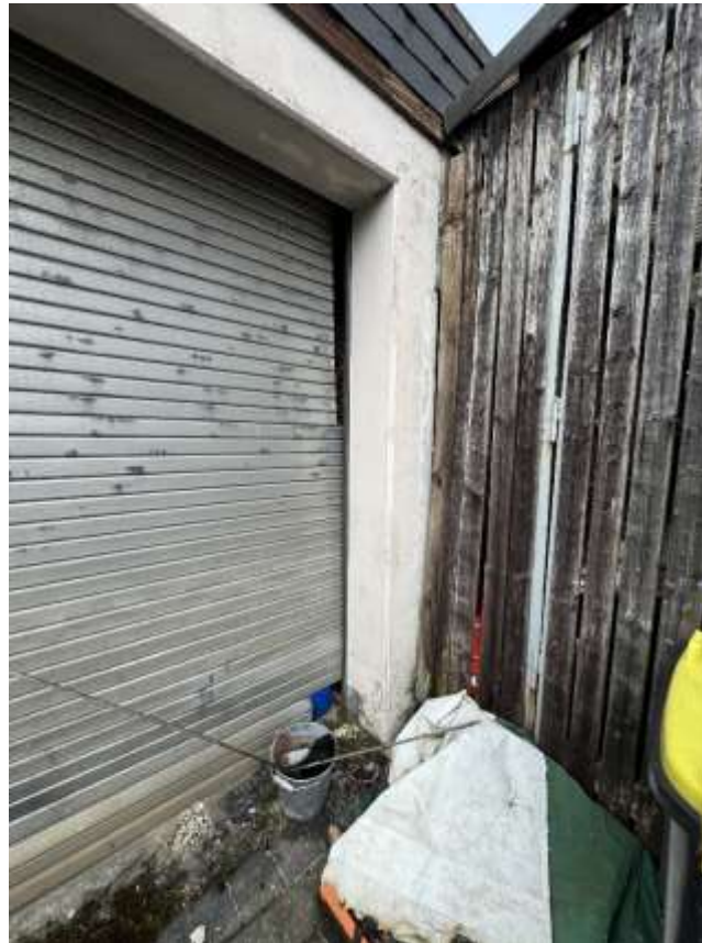
Bild 15: Beispiel für beschädigtes Garagentor
