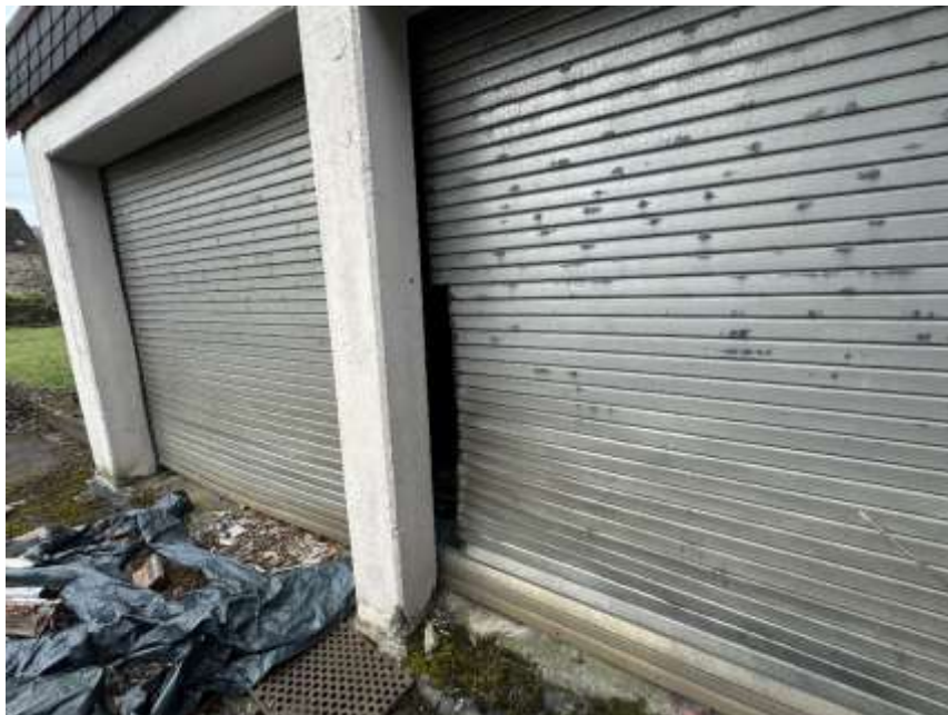
Bild 14: Beispiel für beschädigtes Garagentor
