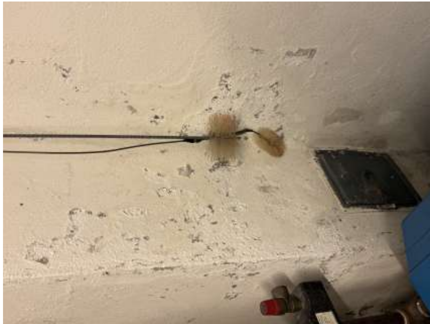
Bild 11: Putzausblühungen im KG
