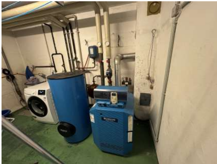
Bild 9: Heizungsanlage im KG
