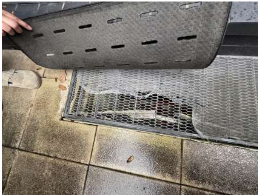
Bild 13: Beispiel für gebrochenen Lichtschacht
