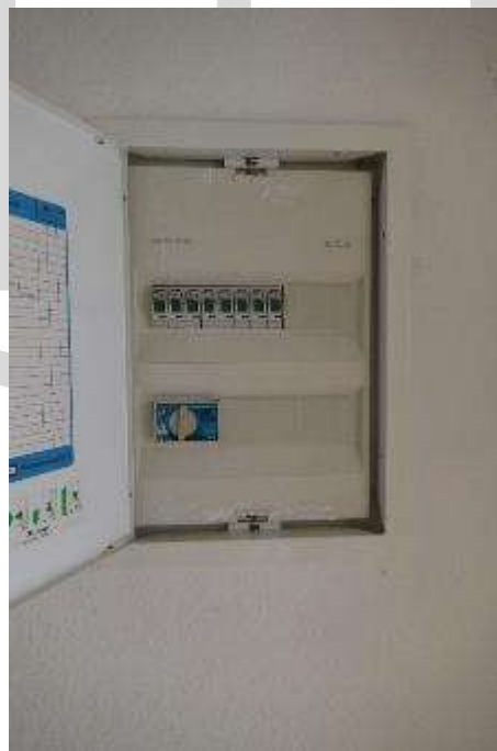
Bild 18 Beispiel einer Elektrounterverteilung
