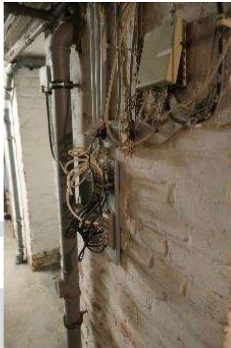
Bild 13 Kabelanschluss im Kellergeschoss
