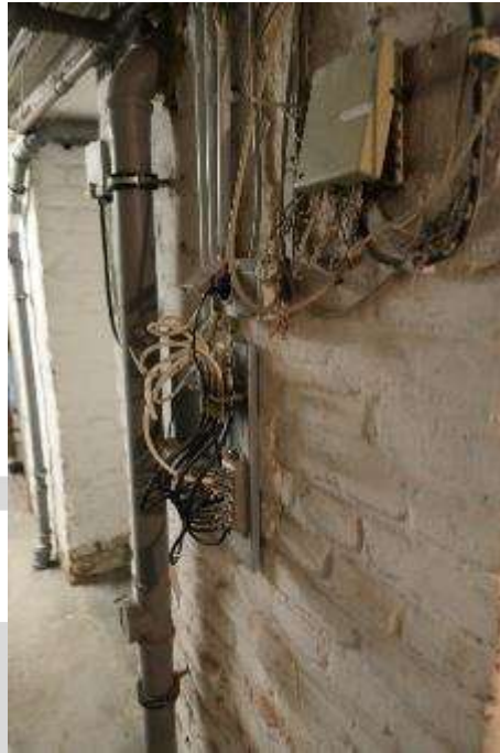
Bild 13 Kabelanschluss im Kellergeschoss
