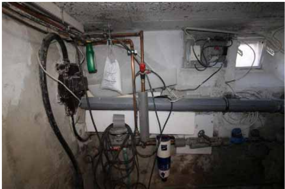
Sicht auf Anschlüsse im Flur / KG
