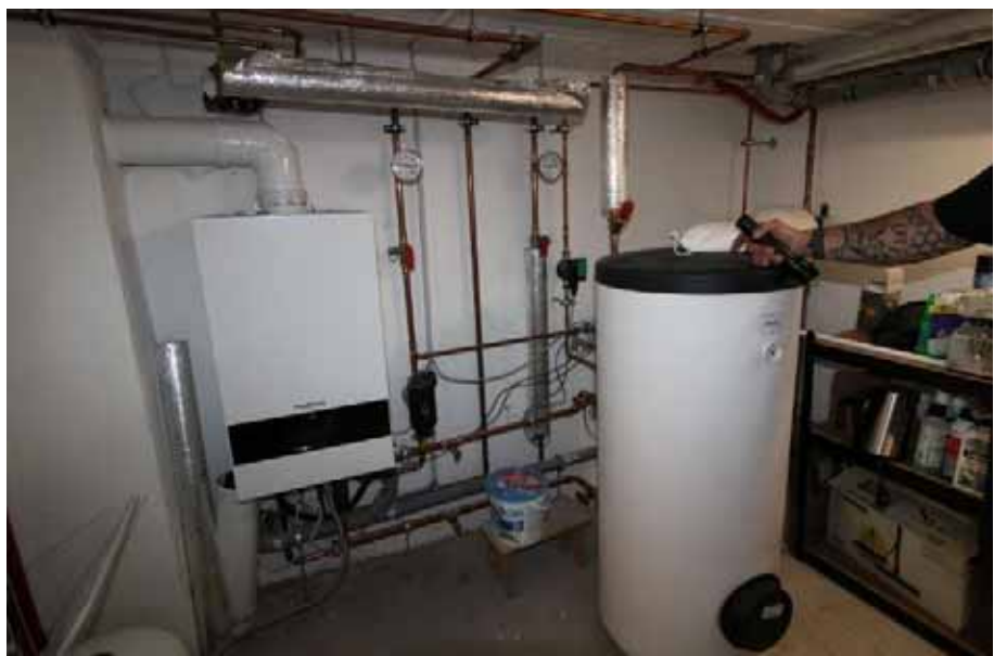
Sicht in den Heizraum / KG
