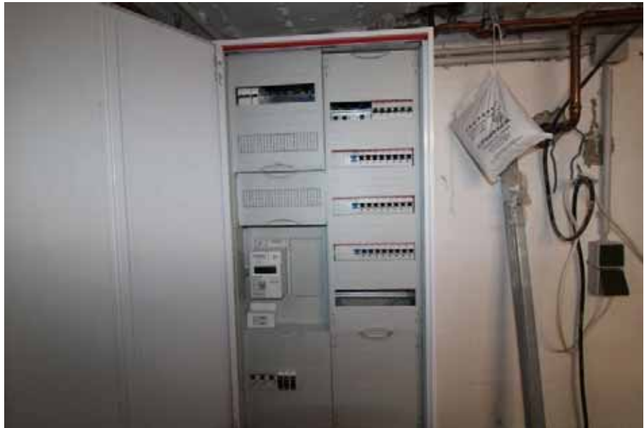
Sicht auf die Elektro- unterverteilung / KG
