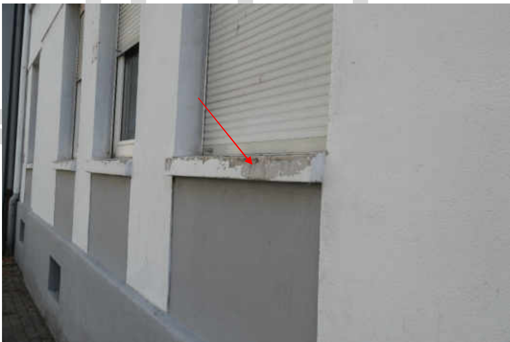
Bild 12 Bauschaden an der Fassade
