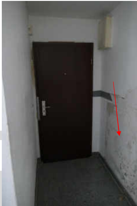
Bild 21 Flurbereich mit Wohnungseingangstür und Feuchtigkeitsschaden
