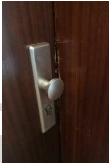
Bild 13 Schaden an der Wohnungseingangstür
