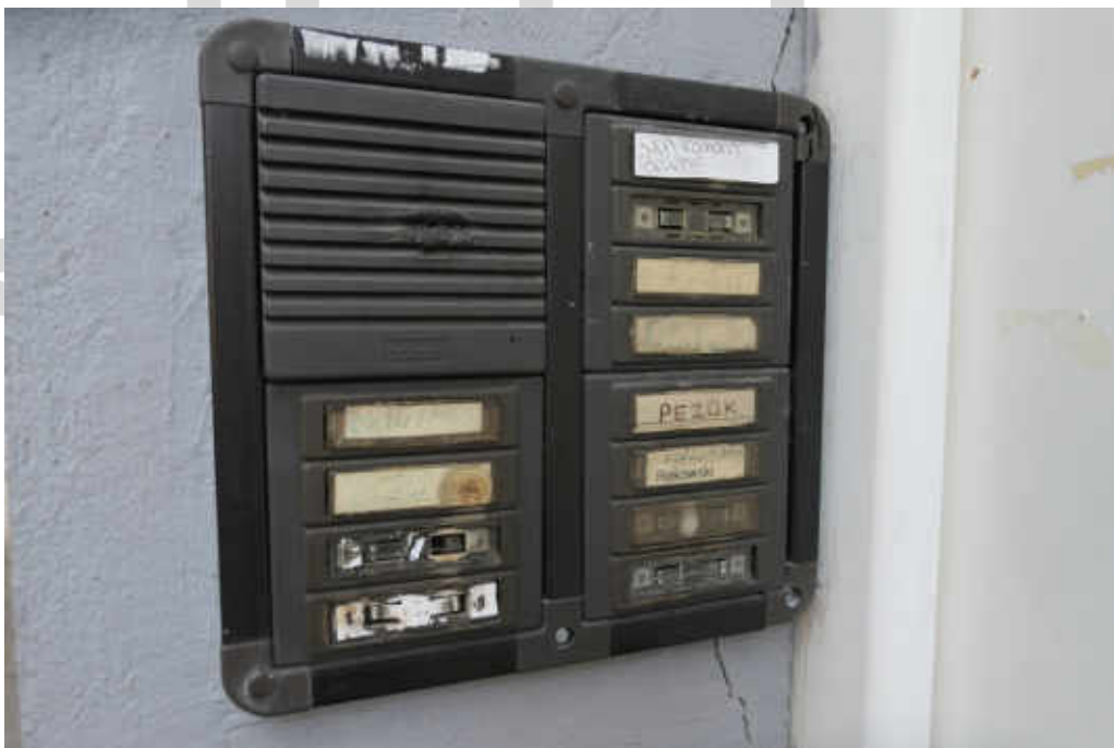
Bild 6 Sprechanlage des Hauses
