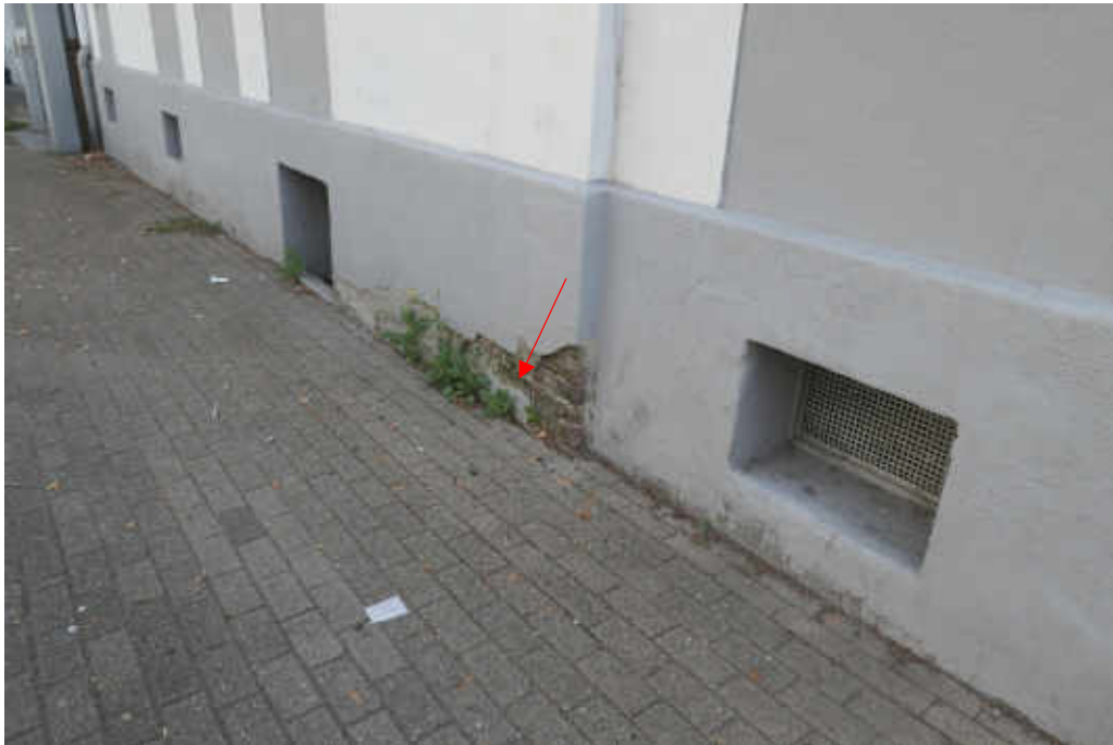
Bild 11 Bauschaden am Fassadensockel
