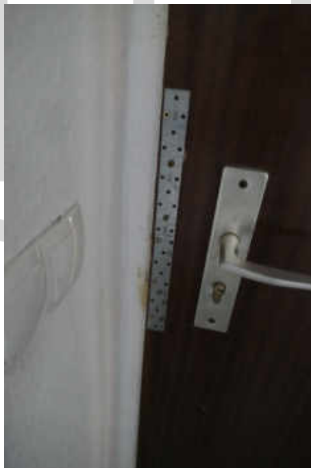
Bild 22 Schaden an der Wohnungseingangstür
