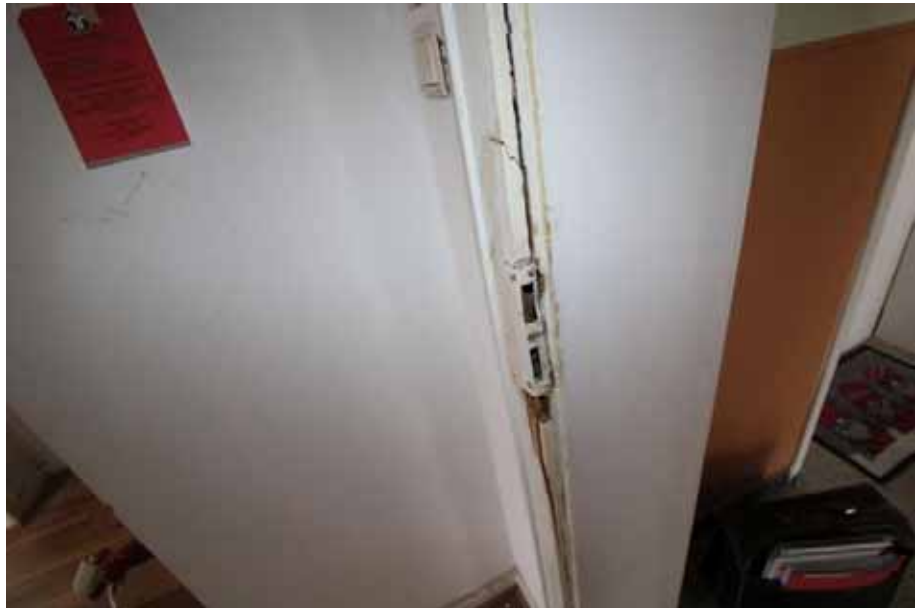
Sicht auf Einbruchspuren an der Wohnungstür / 2.OG links
