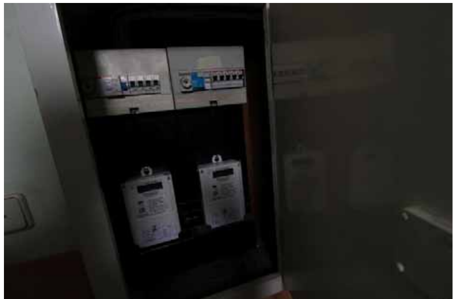
Sicht auf die Stromzähler und Elektroverteilung im Treppenhaus / 2.OG
