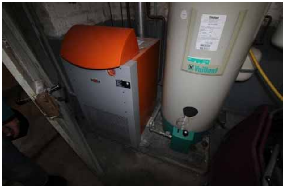
Sicht auf den Heizkes- sel und Warmwasser- tank der Wohnung EG in einem Kellerraum / KG
