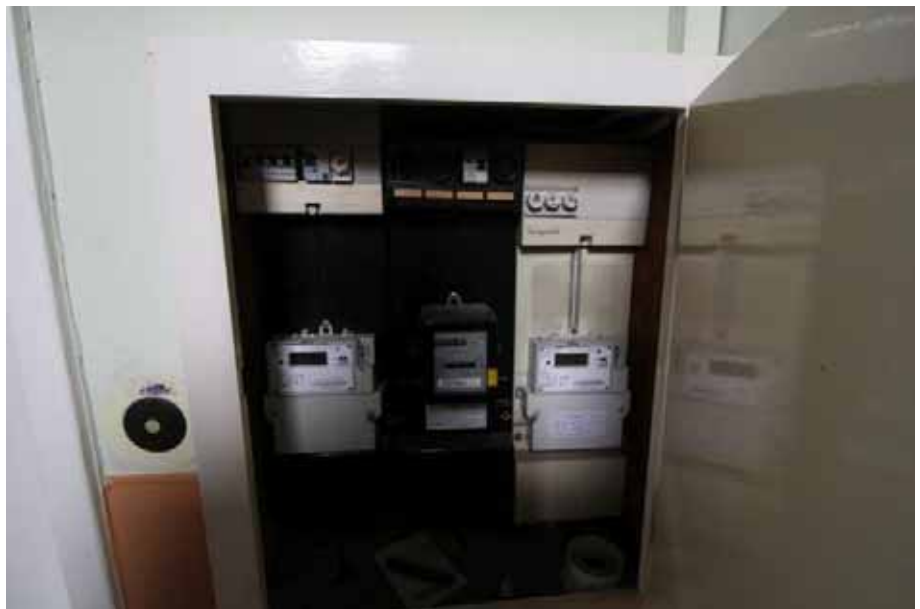
Sicht auf die Stromzähler und Elektro- unterverteilung im Treppenhaus / 3.OG
