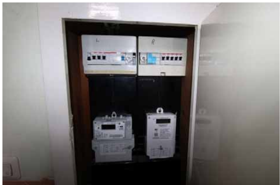
Sicht auf die Stromzähler und Elektroverteilung im Treppenhaus / 1.OG
