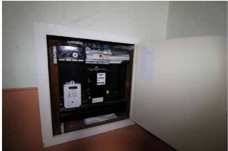
Sicht auf die Stromzähler und Elektroverteilung im Treppenhaus / EG
