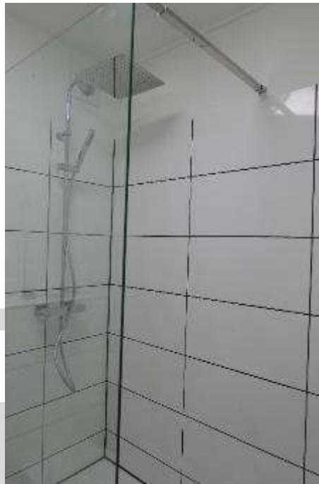
Bild 31 Dusche im Badezimmer
