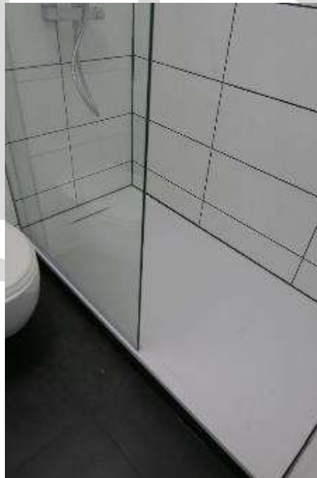
Bild 30 Dusche im Badezimmer
