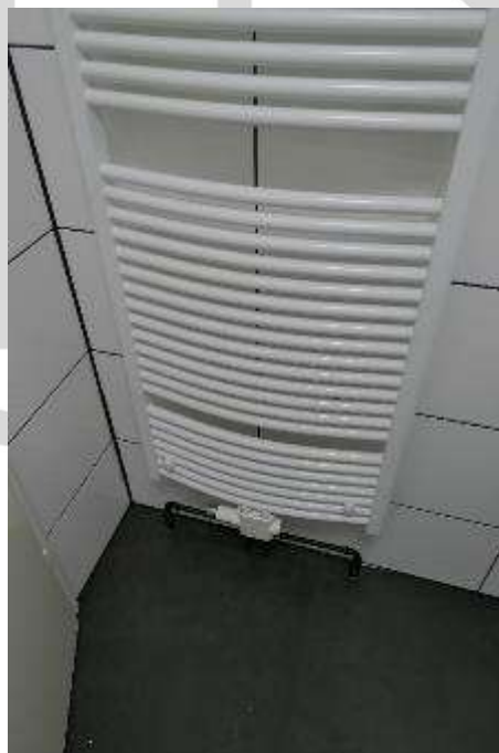
Bild 32 Heizkörper im Bad
