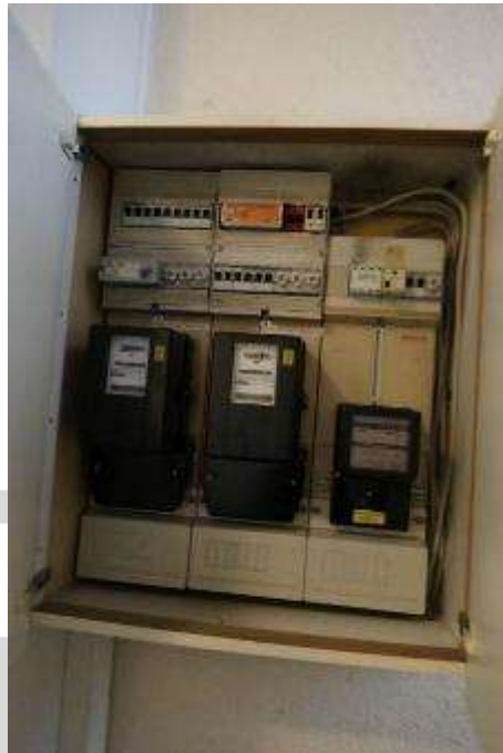
Bild 23 Zählerkasten im Treppenhaus
