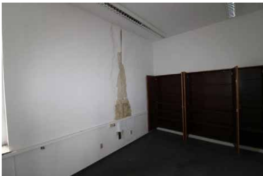
Sicht auf einen Feuch- teschaden an der Au- ßenwand zum Lichthof /1.OG Haus 1 (Sham- rockring 1)
