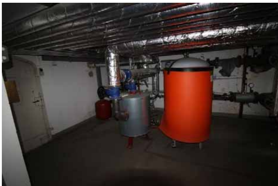
Sicht in den Heizraum/ UG Haus 1 (Sham- rockring 1)
