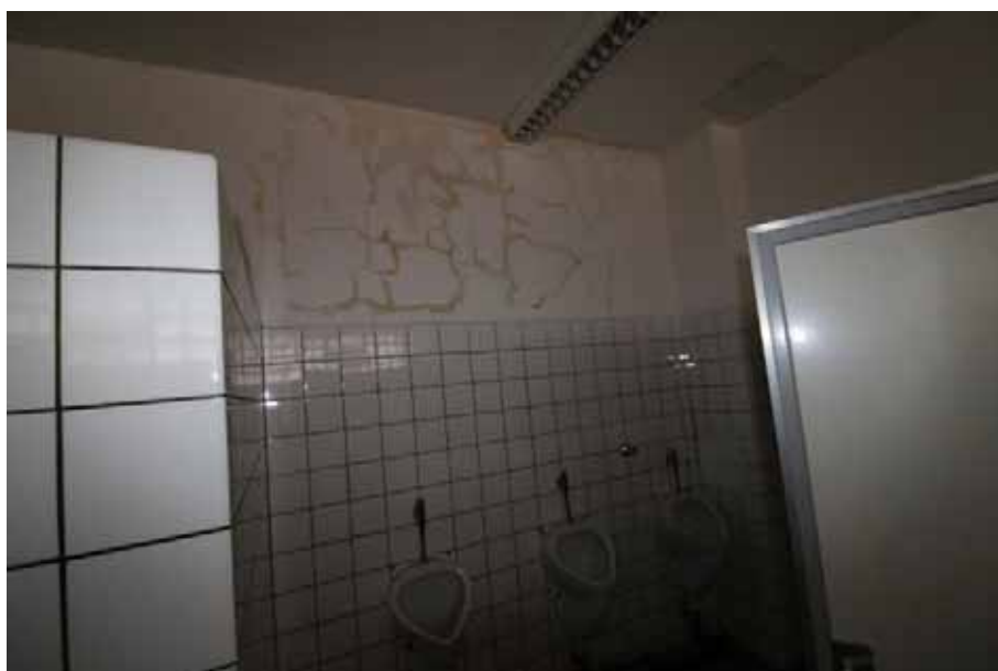
Sicht auf einen Feuch- teschaden an der Wand in einem WC /1.OG Haus 1 (Sham- rockring 1)
