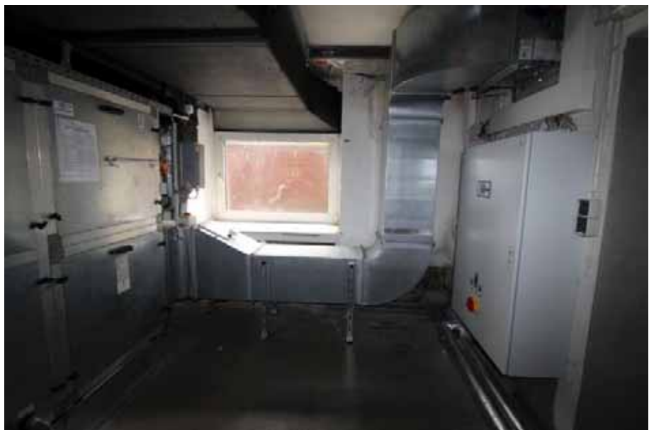
Sicht in einen Technik- raum/UG Haus 1 (Shamrockring 1)
