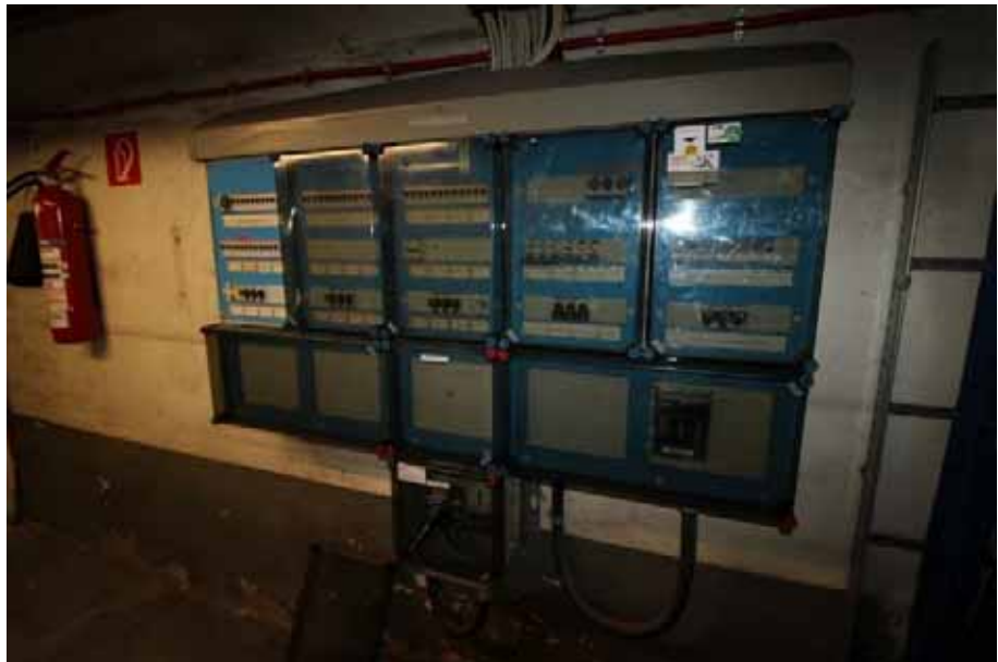
Sicht auf eine Elektro- unterverteilung im Flur/ UG Haus 1 (Sham- rockring 1)
