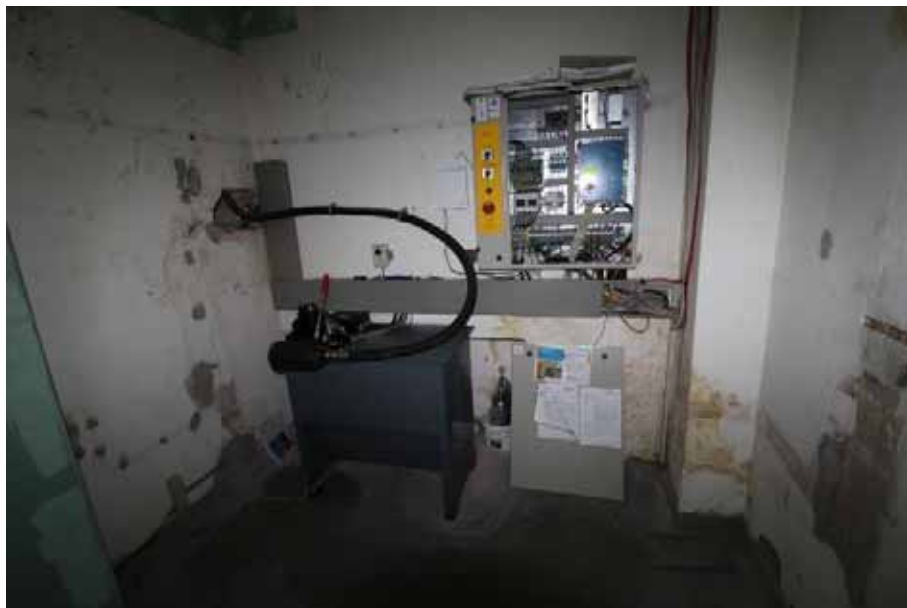
Sicht in den Maschinenraum im Turm/ EG Haus 1 (Shamrockring 1)
