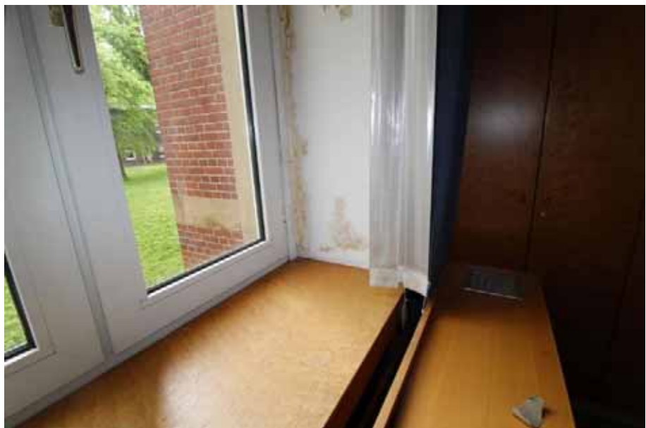
Sicht auf einen Feuch- teschaden mit Schim- melpilzbefall in einer Fensterlaibung/ EG Haus 1 (Sham- rockring 1)
