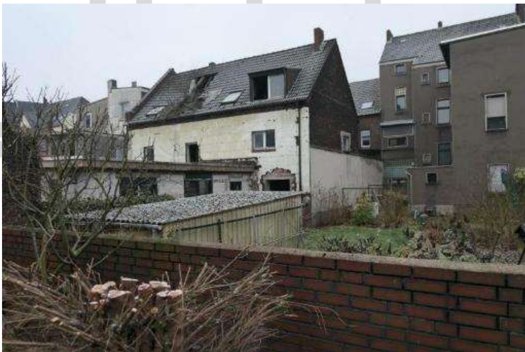
Bild 18 Blick auf die Rückseite des Hinterhauses mit Dachschaden
