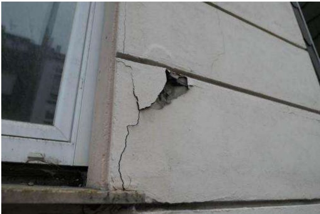
Bild 7 Bauschäden an der Fassade
