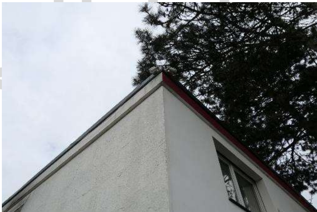
Bild 20 Bauschäden an der Fassade
