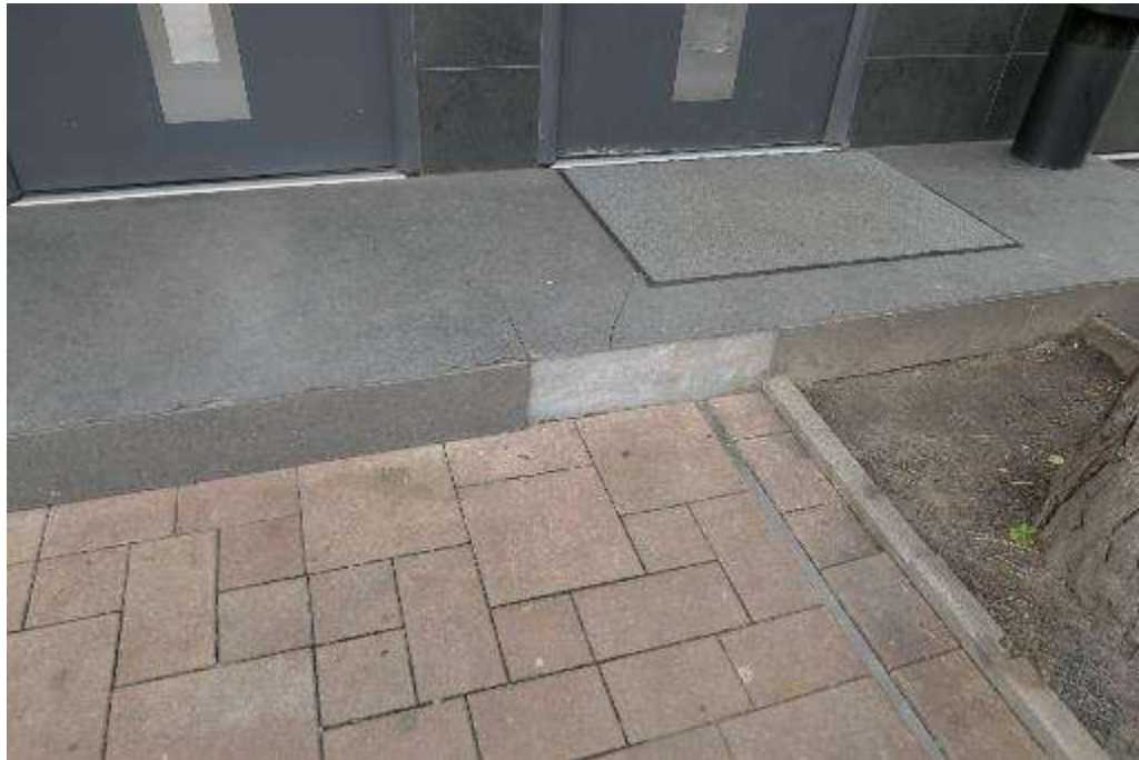
Bild 15 Haupteingang mit Bauschäden
