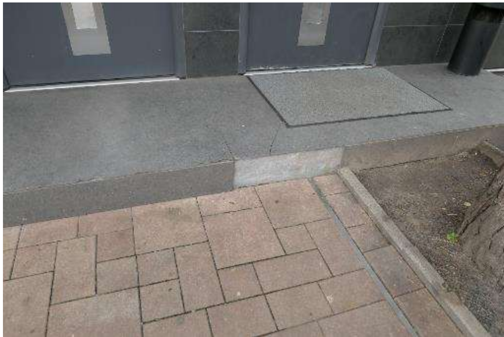
Bild 15 Haupteingang mit Bauschäden
