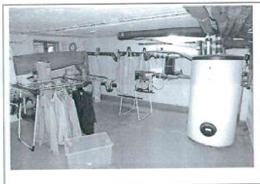
Foto 14 Heizung und Trockenraum
