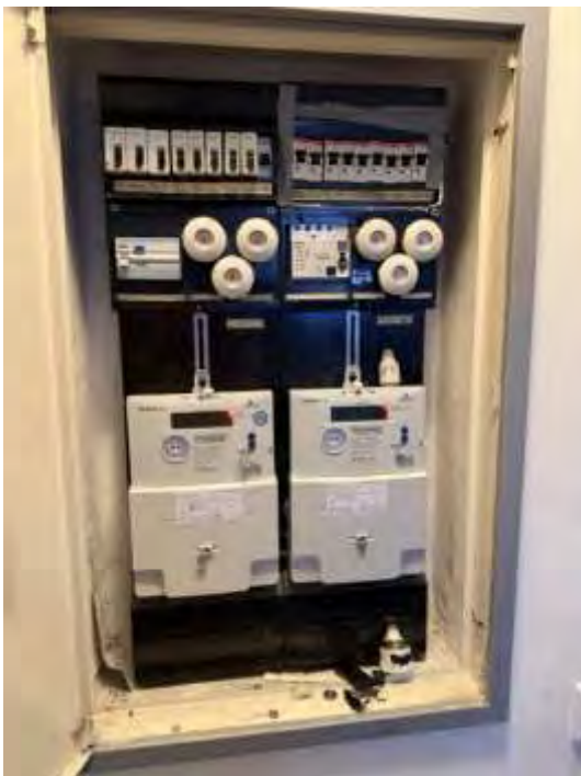
Elektro-Unterverteilung u. Stromzähler im Treppenhaus
