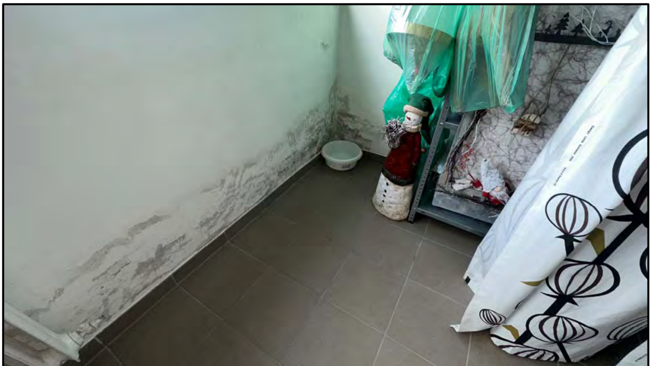
Feuchtschäden im Hobbykellerraum
