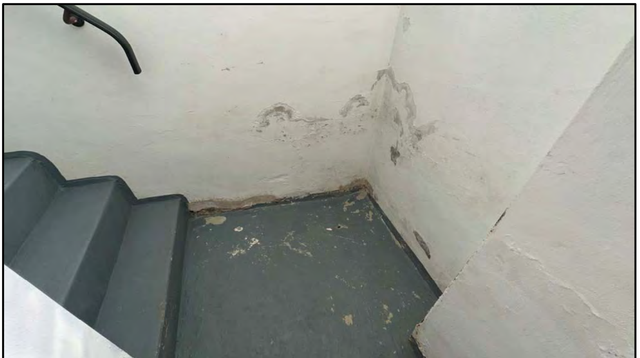
Feuchtschäden im Bereich der Kelleraußentreppe
