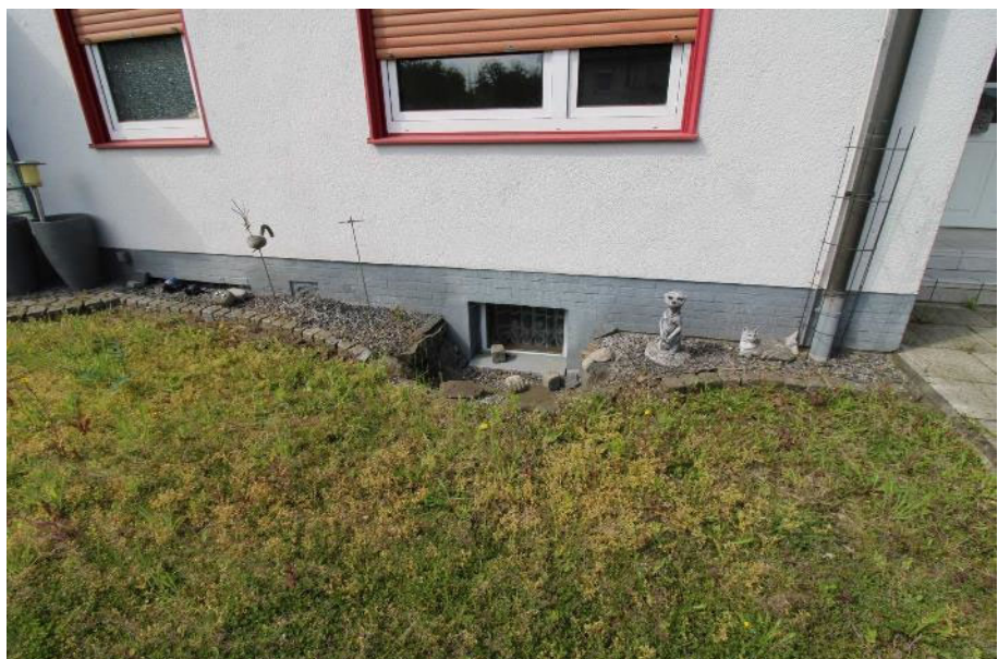
Sicht von der Katharinastraße aus auf ein Kellerfenster an der Vorderseite des zu bewertenden Objekts
