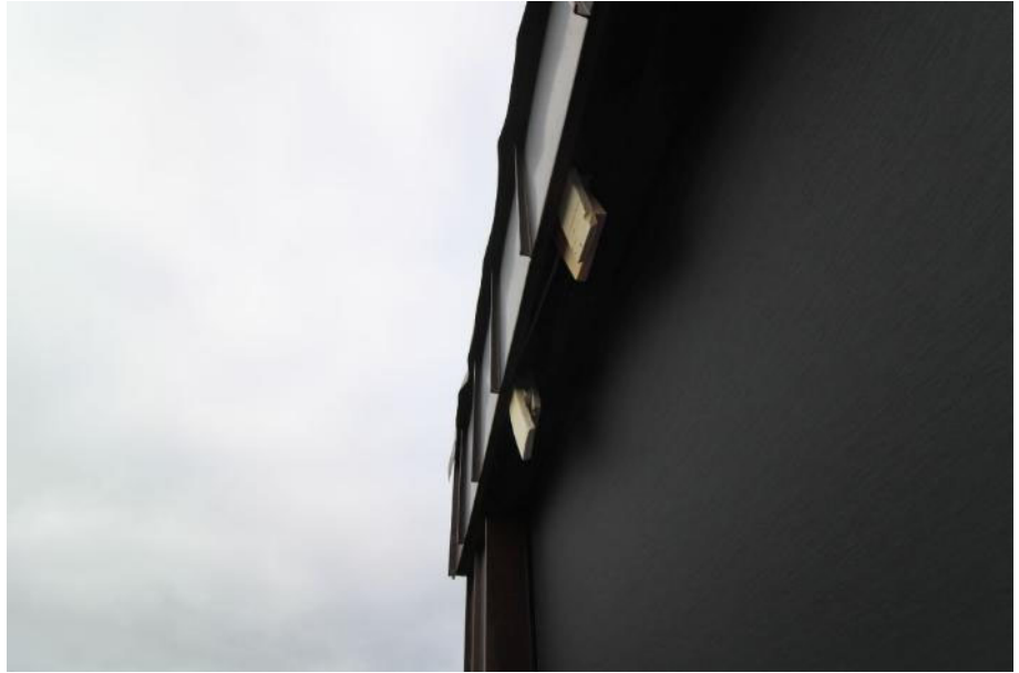
Zustand Kupferverkleidung Gaube
