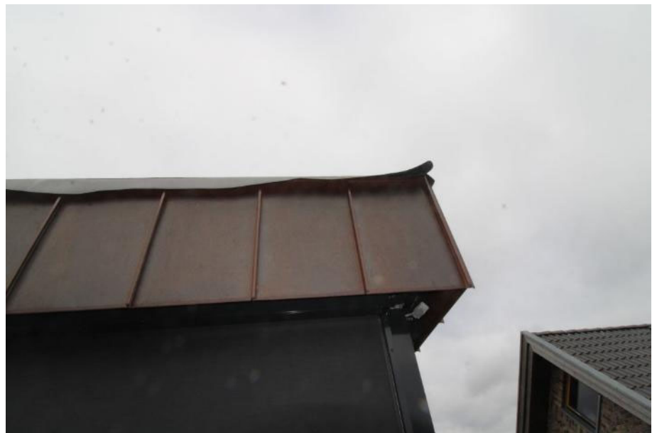
Kupferverkleidung Gaube Zustand (Nord- ostecke)
