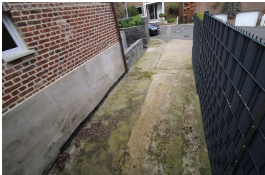
Über eine Baulast gesicherter Stellplatz
