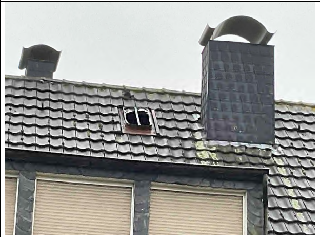
Foto 10: Blick aus nördlicher Richtung auf die zerstörte Dachluke, Niederschlagwasser kann ungehindert in das Wohnhaus gelangen
