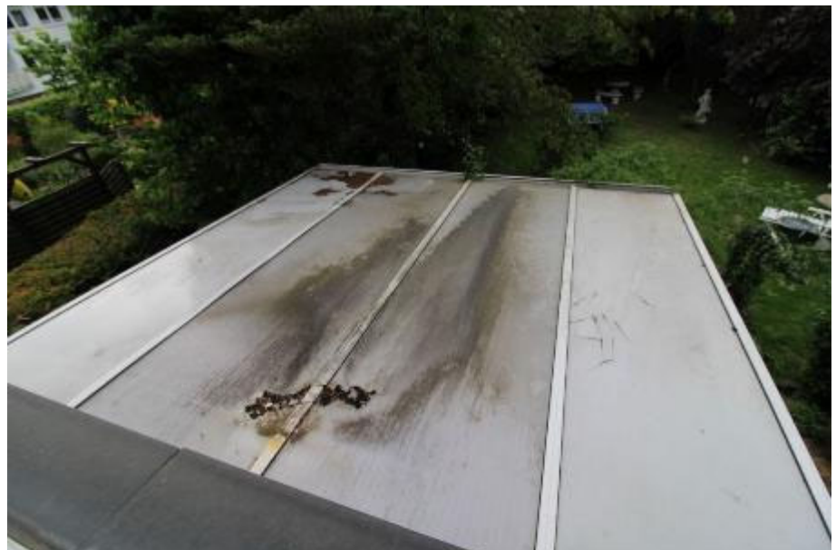
Zustand Dach Winter- garten
