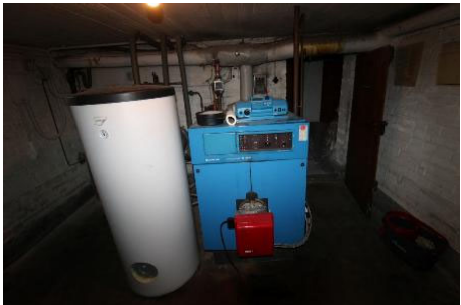
Heizung mit Warmwasseraufbereitung
