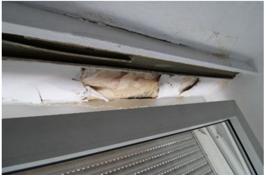
Zustand Kinderzimmer Dachgeschoss Gaube
