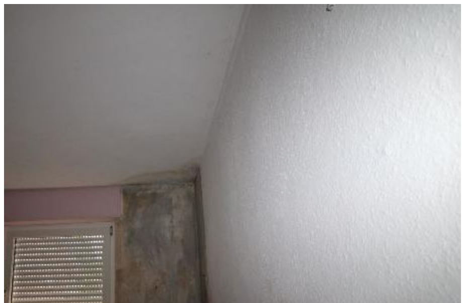
Zustand Zimmer zur Straße, rechte Ecke Obergeschoss
