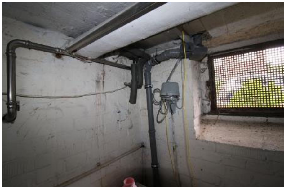
Waschkeller, Telefonanschluss und Leitungen
