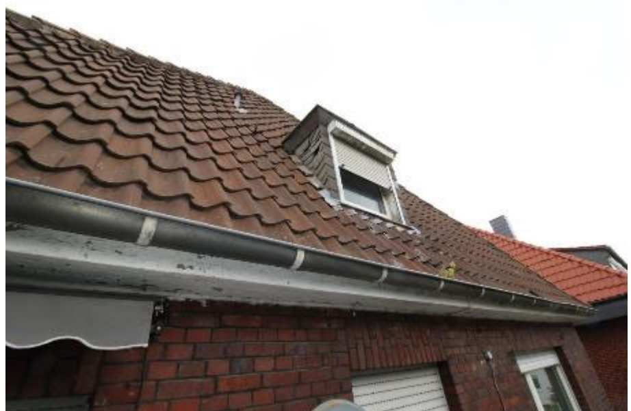
Zustand Dach und Gaube zum Garten
