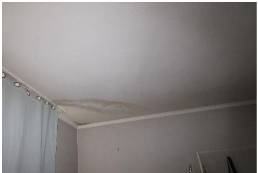
Zustand Wohnzimmer Obergeschoss, rechte oberer Ecke neben dem Fenster
