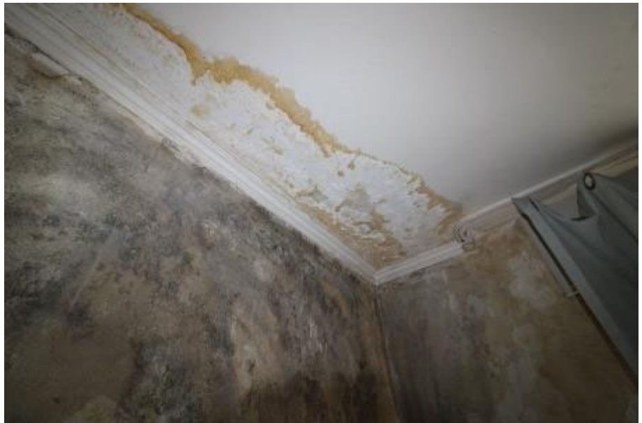
Zustand Wohnzimmer Obergeschoss, linke oberer Ecke neben dem Fenster
