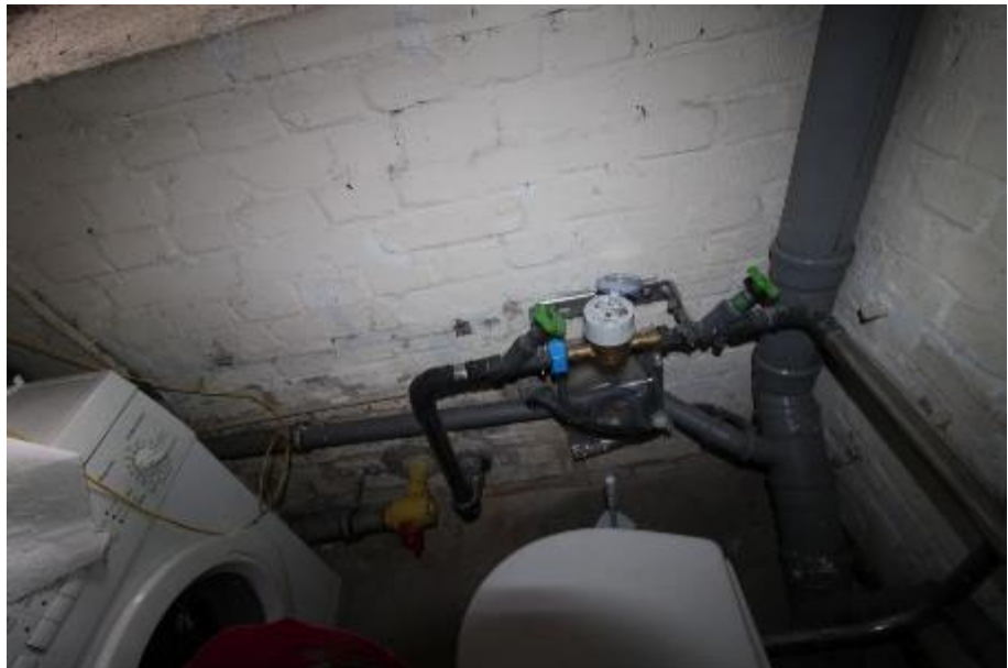
Waschkeller, Wasserleitung und Zähler
