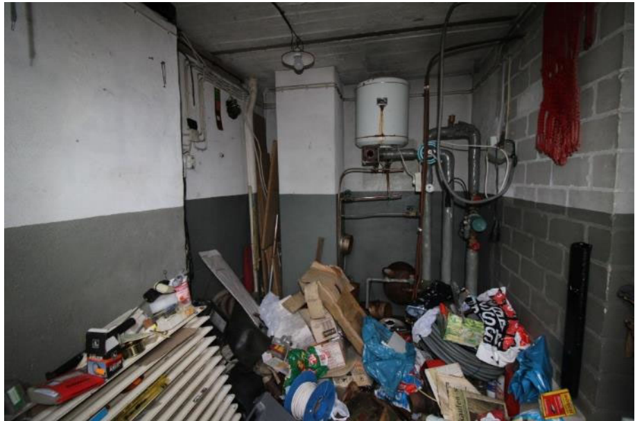
Sicht in den Heizraum / EG
