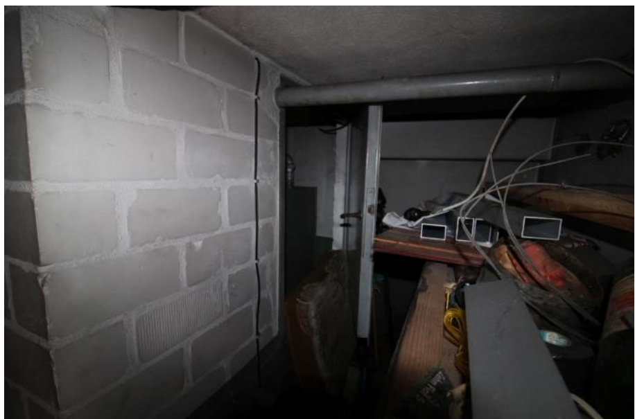
Sicht vom Heizraum aus auf den Tankraum / EG
