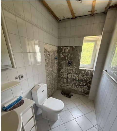
Bild 17: Bad EG, Dusche fehlt wg. Rohrbruch
