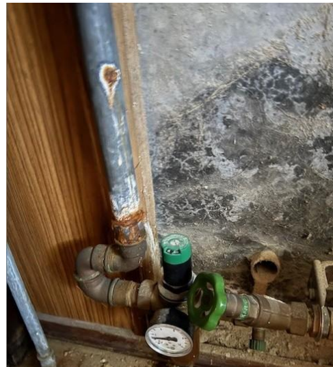
Bild 20: feuchte Außenwände KG
