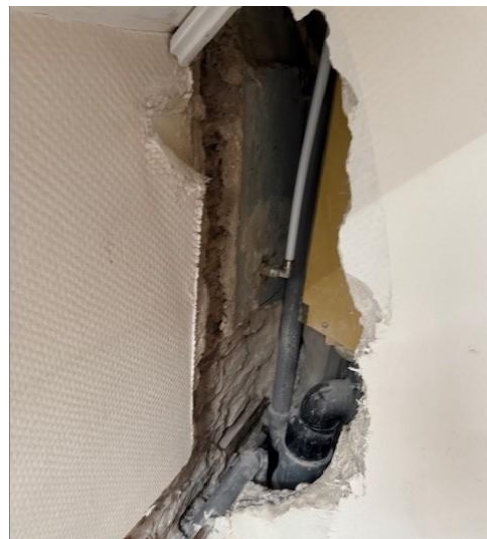
Bild 8: noch nicht behobene Endarbeiten des Rohrbruchs
