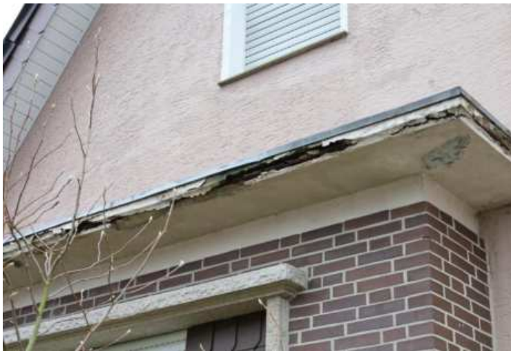
Beschädigtes Dach des Erkers
