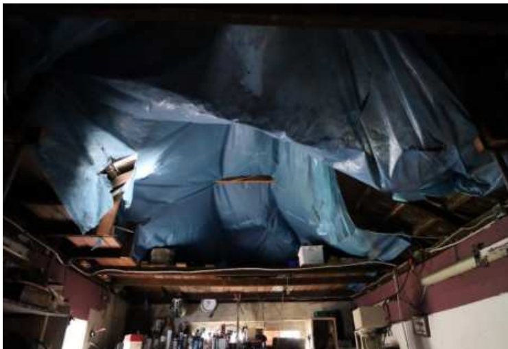
Zustand Dach der Garage, Ansicht von Innen.
