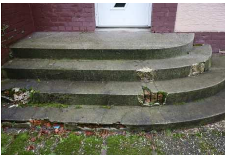
Beschädigte Treppenstufen zum Hauseingang
