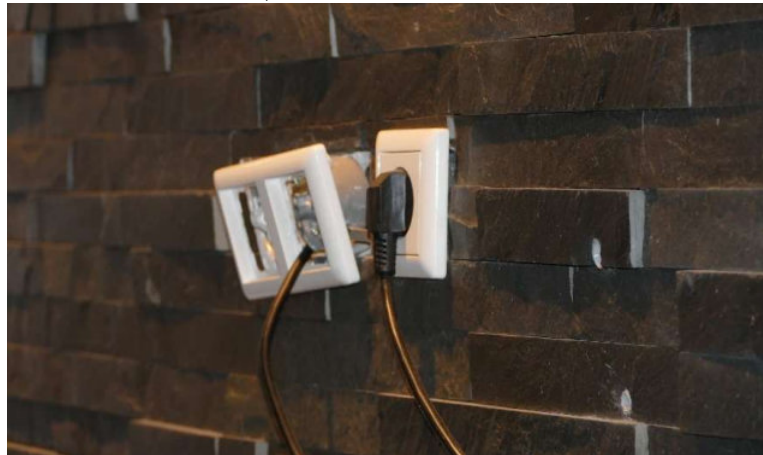
C8 | Schalterabdeckung beschädigt
