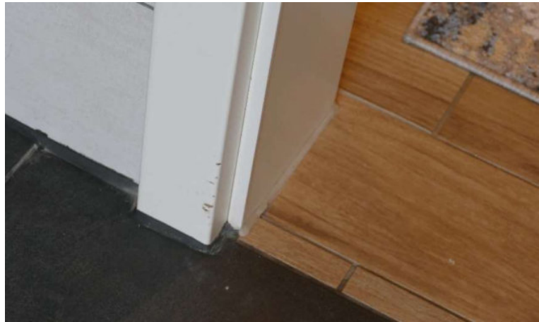
C4 | Zustand Türzarge Bad im DG
