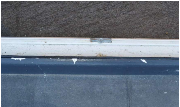
A5 | Zustand der Fenster aus 2015 – Folierung tlw. gelöst
