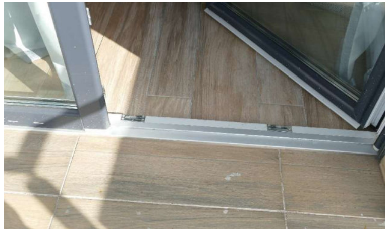
A1 | keine DIN-gerechte Entwässerung (Balkon „straßenseitig“) DIN 18531: mind. 5 cm Aufkantung zzgl. Gewährleistung eines einwandfreien Abflusses (z.B. Entwässerungsrinne)
