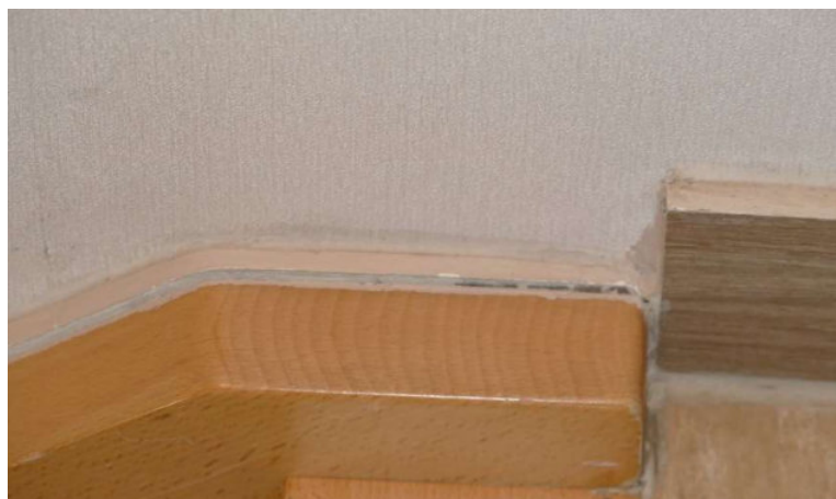
C3 | Treppenwange, augenscheinlich geringfügig abgesackt
