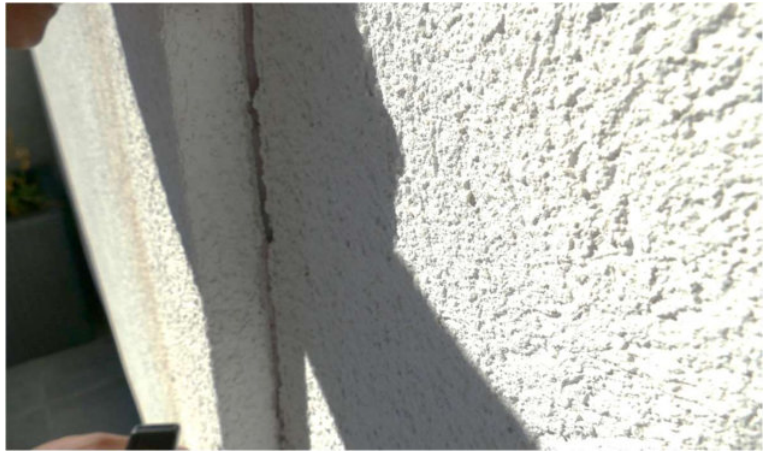
A4 | Wärmedämmplatte tlw. vom Untergrund gelöst, siehe Gutachten des Sachverständigen für Schäden an Gebäuden
