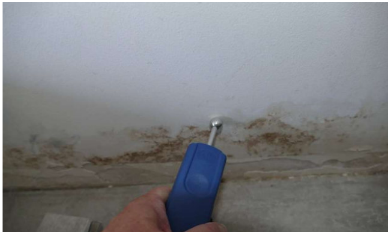
D2 | Feuchtigkeit „Sockelbereich im Schlafzimmer“
