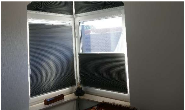
A6 | Pfosten zwischen den Blendrahmen des Eckfensters fehlt Öffnung der Fenster nur jeweils einseitig möglich
