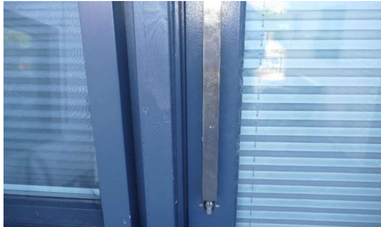
B1 | Zustand der Außentür zur Terrasse: z. T. deutliche Gebrauchsspuren, Rosette am Schließzylinder fehlt
