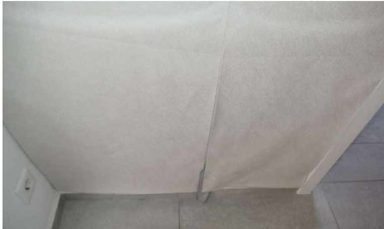
D1 | Feuchtigkeit in der Wand zwischen Flur und Bad „innenliegende Regenentwässerung des Flachdachs“
