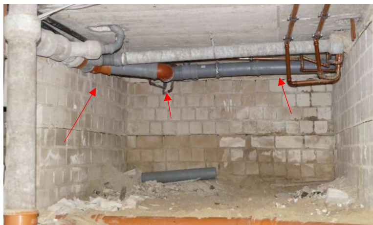
B3 | Zustand der Entwässerungsleitung (Schmutz-/Regenwasser) tlw. mit Gegengefälle, siehe Gutachten des Sachverständigen für Schäden an Gebäuden
