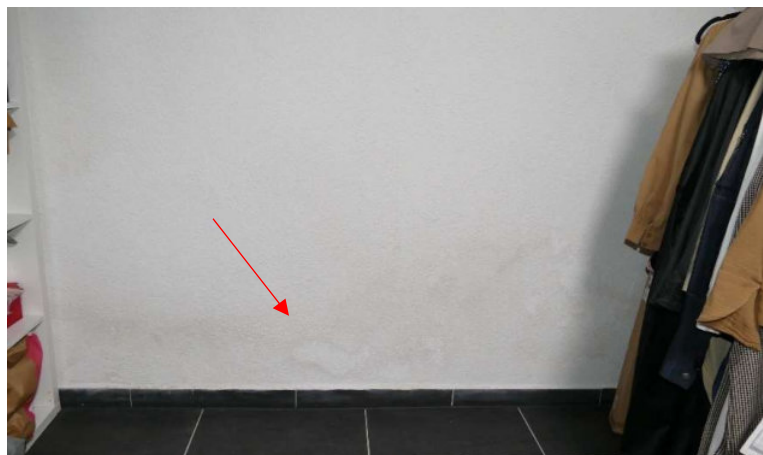
C9 | Feuchtigkeit im Außenmauerwerk des Kellergeschosses Messwerte zwischen 72-85 Digit
