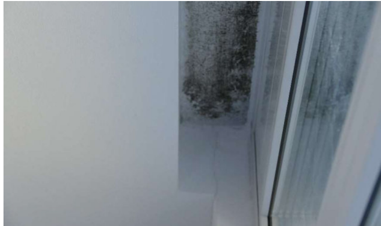
C7 | Lt. Gutachten des Sachverständigen Feldhaus: starke Dunkelfärbung im Fensteranschluss unterhalb der Geschosdecke, unterhalb des Balkons
