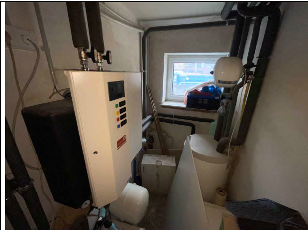
Foto 13: Hausanschlussraum (HAR) im EG
