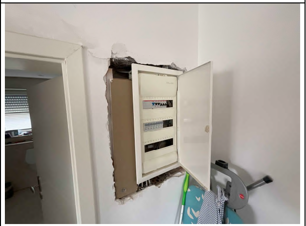
Foto 16: Elektroinstallation im DG
