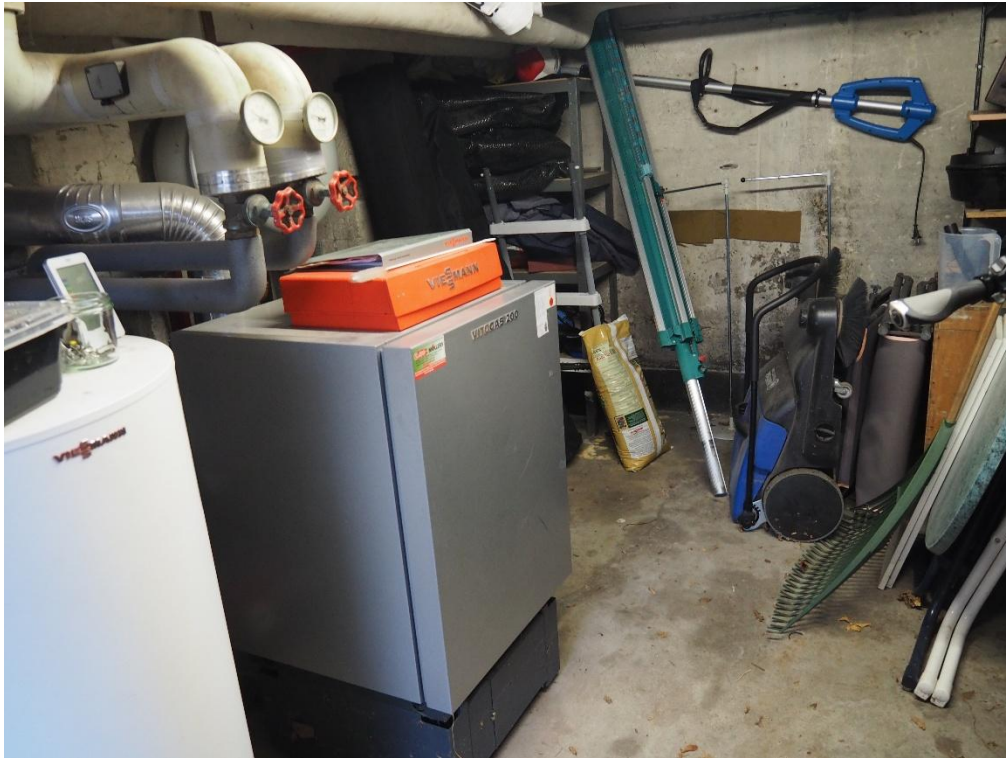
Foto 5: Heizungsanlage im Kellergeschoss
