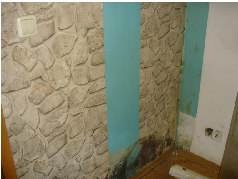
Durchfeuchtung unterer Wandbereich Wohnzimmer (Erdgeschoss Westen)
