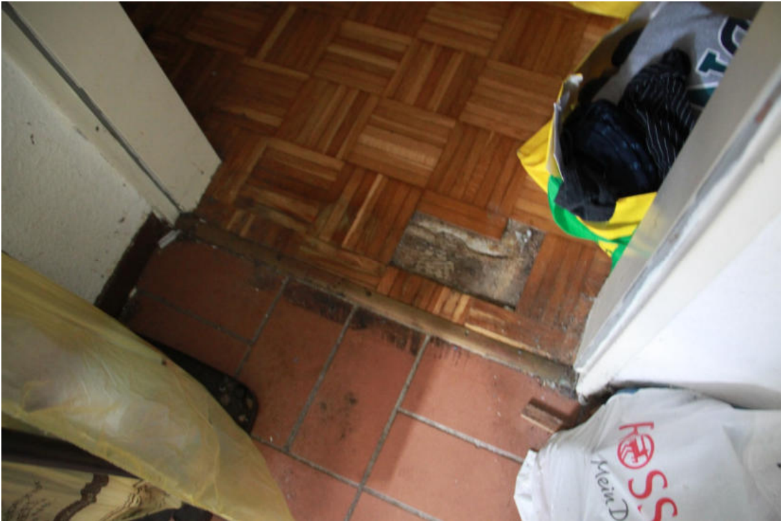
Schaden am Parkettboden
