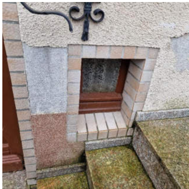
Abgelöster Putz an der Fassade
