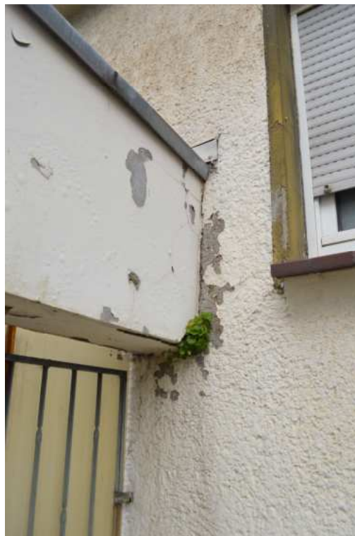
Bild 14: Rissbildung / Abplatzungen Übergang Garagengebäude und Wohnhaus
