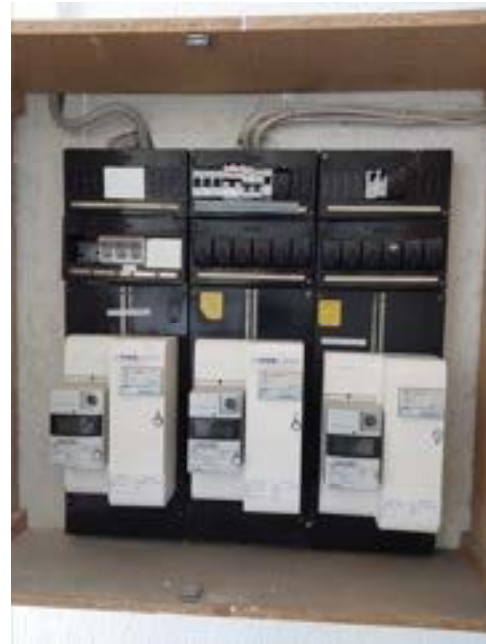
Bild 10: Bsp. Zähler und Elektro- unterverteilung
